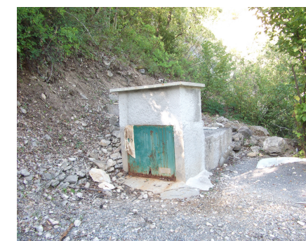
Chloration en ligne
