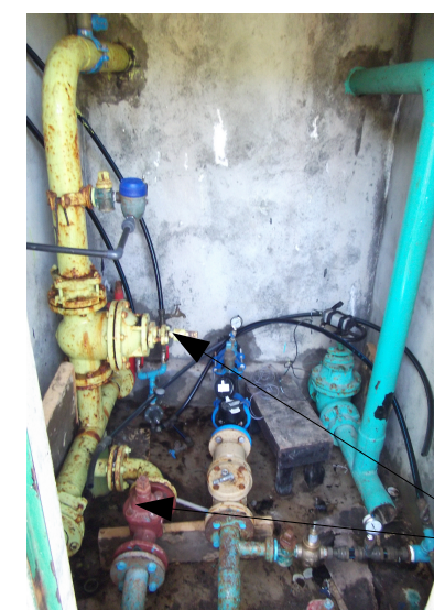
Vue Intérieure (chambre de vanne)
