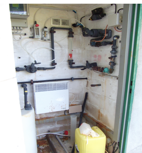
Vue Intérieure (chloration réservoir)
