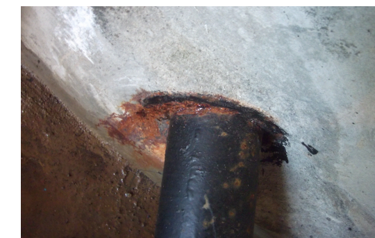
Léger ruissellement sur la canalisation de vidange Vue Intérieur (chambre des vannes)
