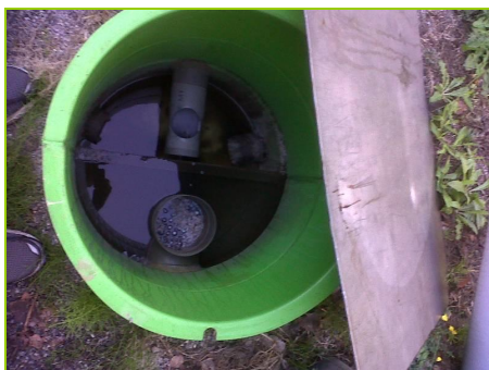
Figure 72 : Le limiteur de débit
