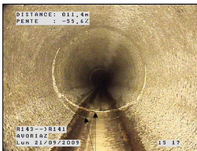
R.143 bis à R.141 : Fissure hélicoïdale marquée avec exfiltration des eaux usées
