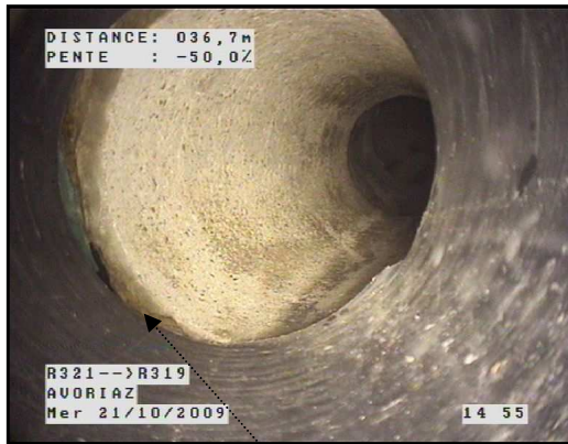
R.321 à R.319 : Exfiltration par déboitement
