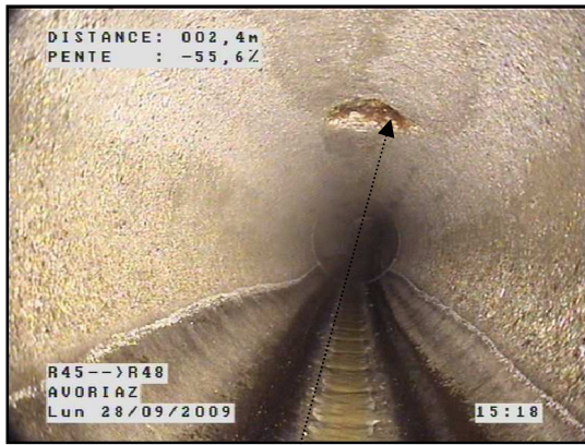
R.45 à R.45bis : Trou dans la voute supérieure
