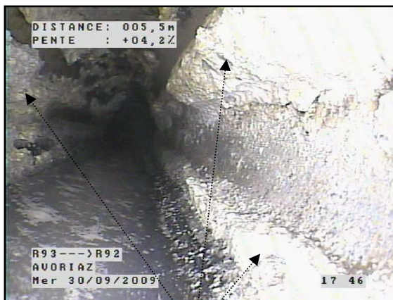
R.93 à R.92 : Dépôts / Graisses adhérents sur les parois
