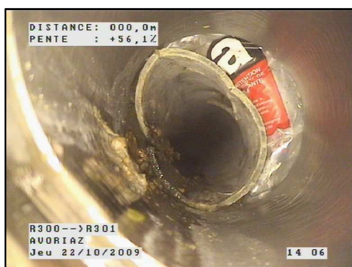
R.301 à R.300 : Effondrement du réseau
