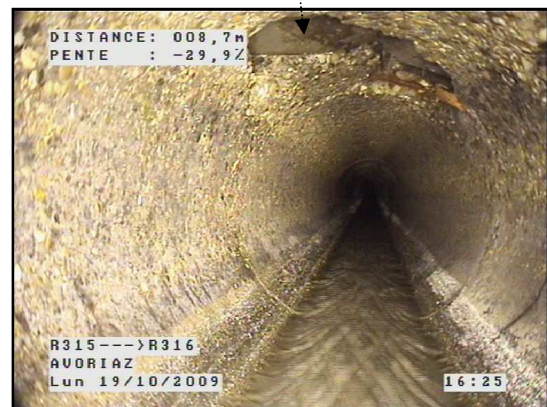
R.315 à R.316 : Effondrement de voute supérieure, infiltration
