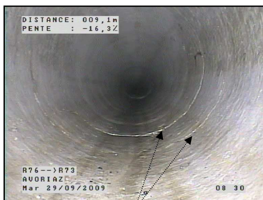
R.76 à R.73 : Deux fissures circonférentielles ouvertes rapprochées
