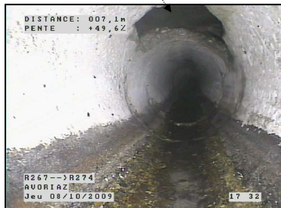
R.274 à R.267 : Trou dans la voute supérieure
