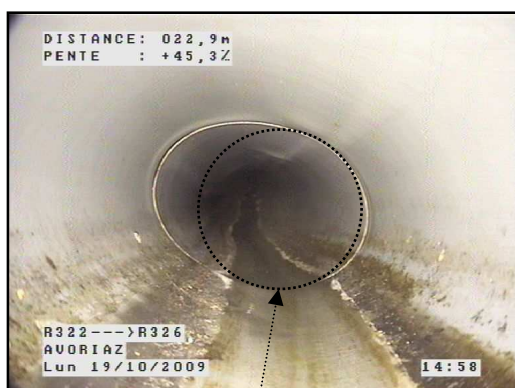
R.326 à R.322 : Déformation du réseau en PVC
