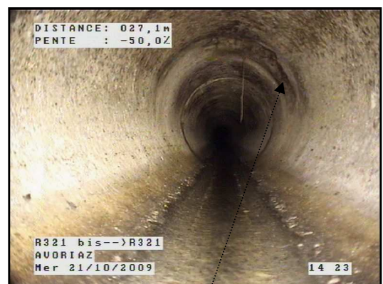
R.321b à R.321 : Infiltration eaux parasites par trou dans la voute
