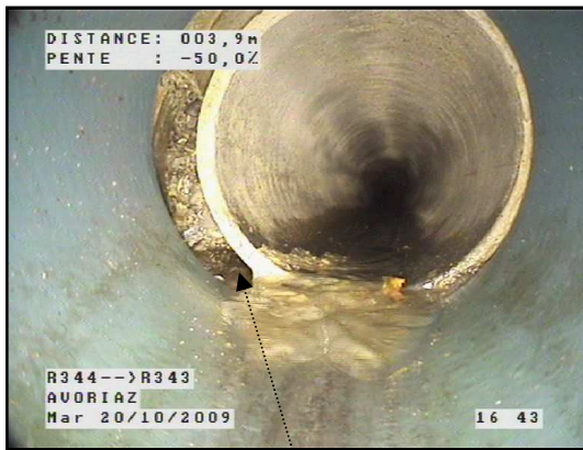
R.344 à R.343 : Changement de matériaux entraînant une exfiltrations
