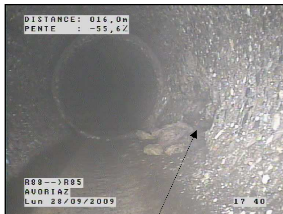
R.88 à R.85 : Effondrement paroi inférieure / sol visible par le défaut / exfiltration
