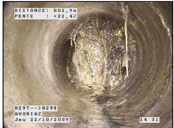
R.298 à R.297 : Suintement, infiltration
