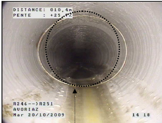
R.251 à R.246 : Tuyau PVC déformé
