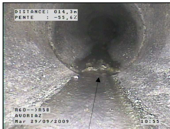
R.60 à R.58 : Fissure circonférentielles ouvertes / sol visible / exfiltration.
