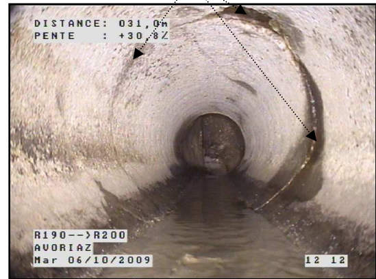
R.200 à R.201 : Fissure circumférentielle / dégradation de paroi / trou dans la voute supérieure / infiltration
