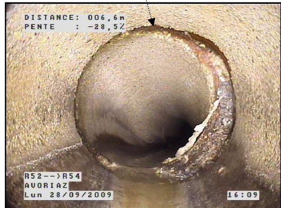
R.52 à R.54 : Déboitement longitudinale / Infiltration et Exfiltration
