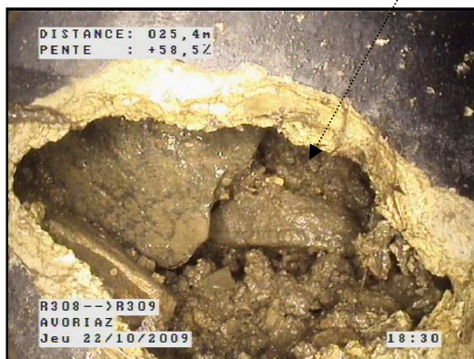
R.309 à R.308 : Rupture dans la paroi, sol visible
