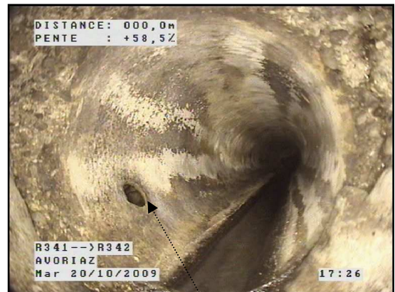
R.342 à R.341 : Trou dans la paroi pouvant entraîner des exfiltrations
