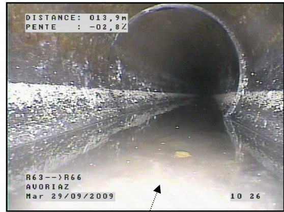
R.66 à R.63 : Contre-pente / stagnation d'eaux usées
