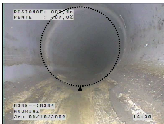
R. 285 à R. 284 : Déformation du tuyau PVC par ovalisation
