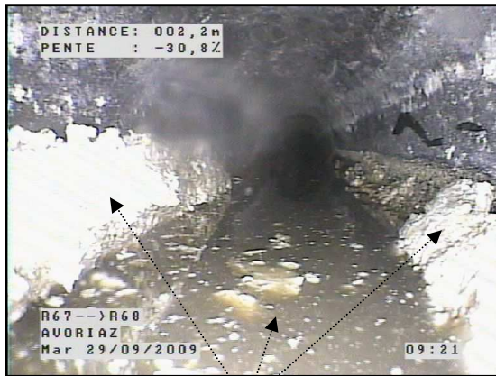
R.68 à R.67 : Contre-pente / stagnation d'eaux usées / dépôts graisseux.
