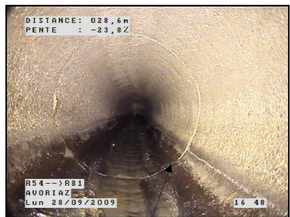
R.54 à R.81 : Fissure circumférentielle ouverte
