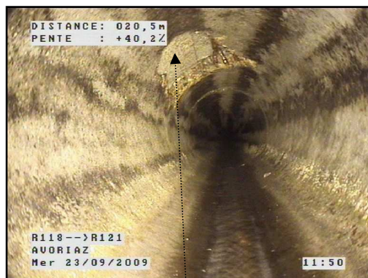
R.121 à R.118 : Dégradation de paroi / trou dans la paroi
