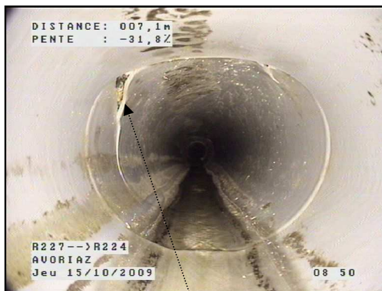
R.227 à R.230 : Fissure hélicoïdale ouverte / infiltration et exfiltration.
