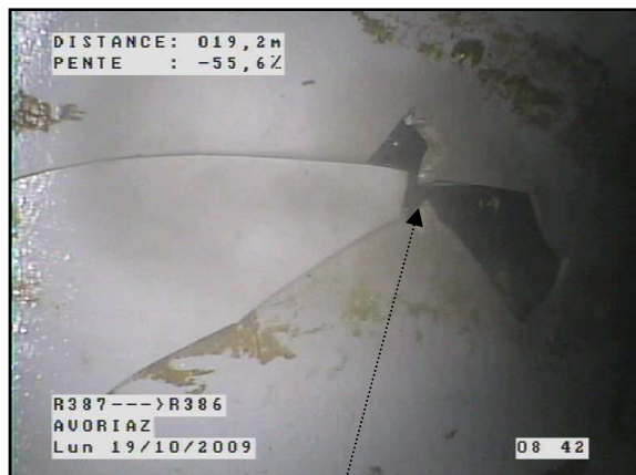
R.387 à R.386 : Fissure et casse du réseau PVC
