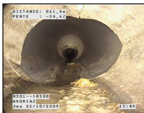
R.301 à R.300 : Effondrement du réseau
