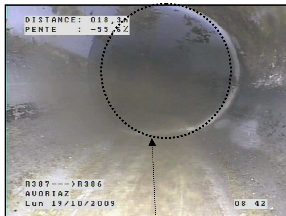
R.387 à R.386 : Déformation du PVC
