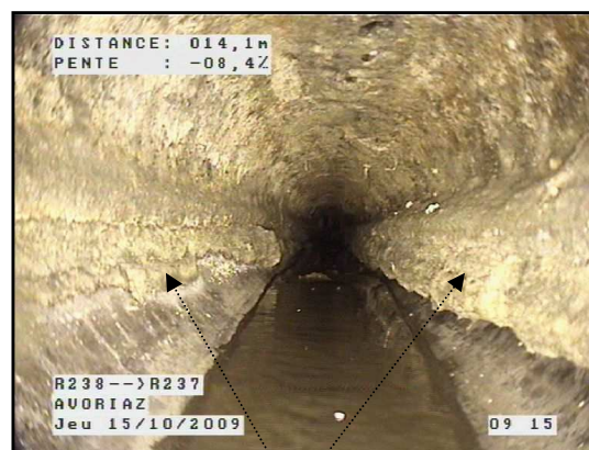
R.238 à R.237 : Dépôts graisseux sur les parois
