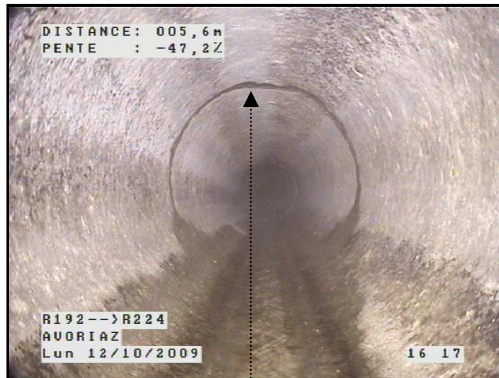
R.92 à R.224 : Fissure circulaire avec trace d'infiltration et infiltration
