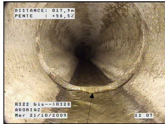
R.328 à R.322b : Exfiltration par déboitement
