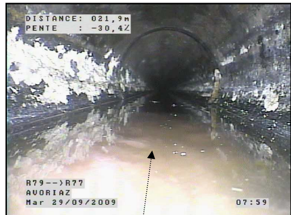
R.79 à R.77 : Contre-pente et stagnation d'eaux usées
