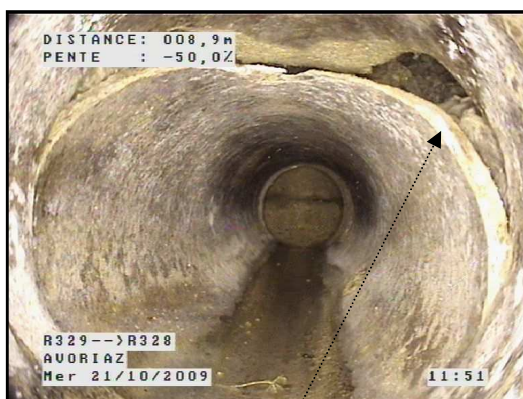
R.329 à R.328 : Infiltration eaux parasites par casse de la voute
