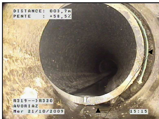
R.320 à R.319 : Infiltration et Exfiltration par déboitement
