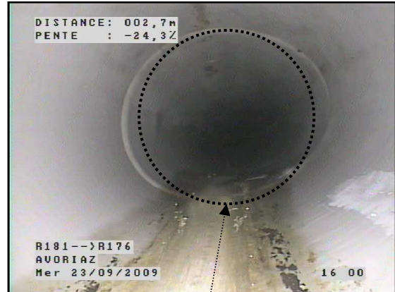
R.181 à R.176 : Tuyau PVC déformé
