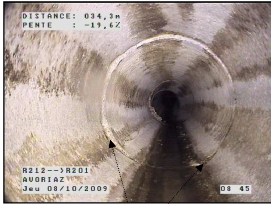
R.212 à R.201 : Dégradation de paroi / sol visible / exfiltration
