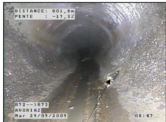
R.72 à R.73 : Trou dans la paroi inférieure / sol visible / exfiltration
