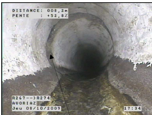
R.274 à R.267 : Grosse fissure circéférentielle avec infiltration et exfiltration
