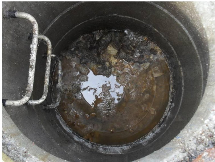
Photo : Présence de dépôt - RV3527-Secteur Chamieux
