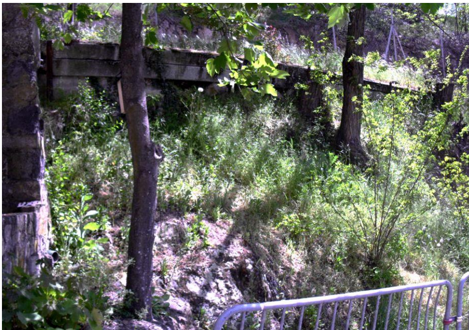
Vue depuis le chemin d'accès à la station du mur de soutènement et des affaissements
