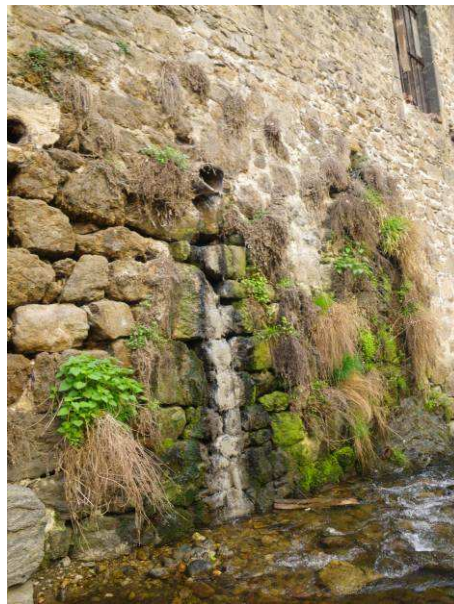
Figure 2-1 : Rejet direct sans traitement en amont du pont de la Cance, rive gauche
