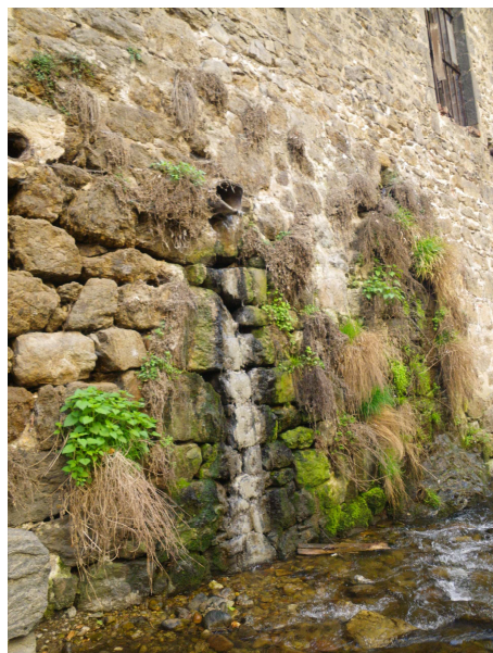
Figure 3-1 : Rejet direct sans traitement en amont du pont de la Cance, rive gauche
