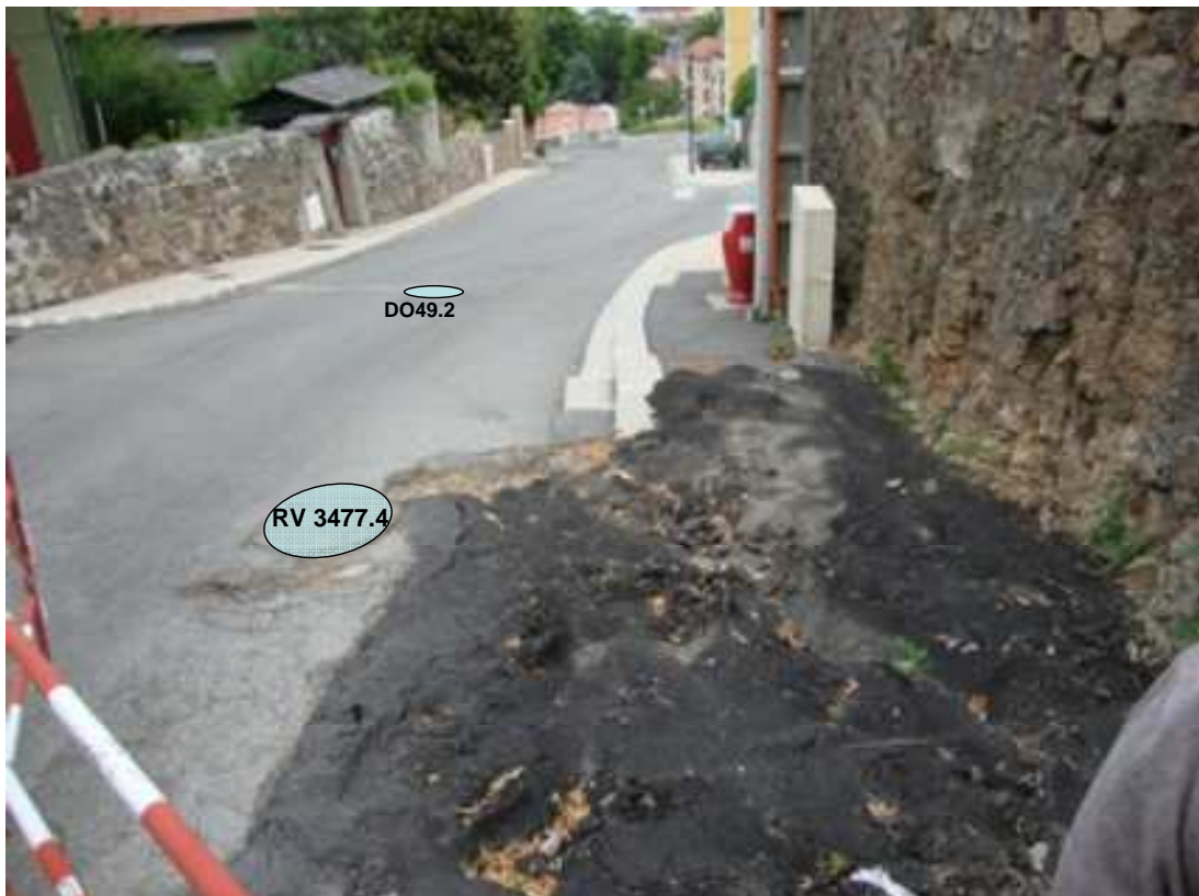
Figure 4-13 : dégradation de la chaussée dans la montée des Aygas
