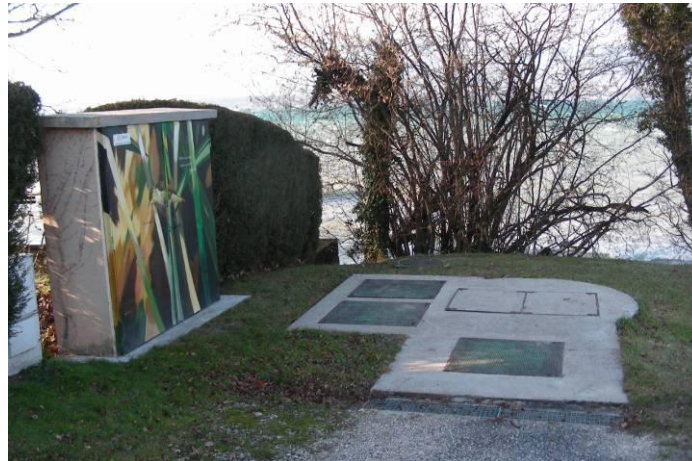
Figure 51 : Poste de refoulement de la Zone de baignade Municipale (Source : photos CIDEE)
