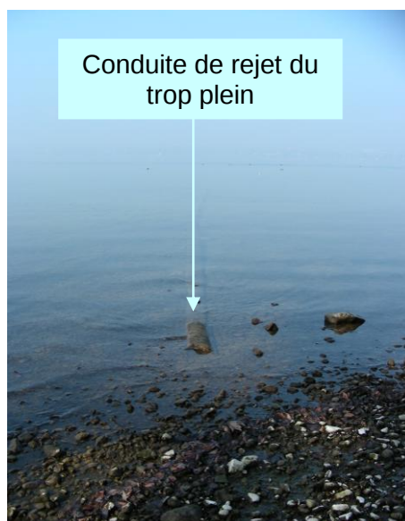
Figure 50 : Trop-plein du poste de refoulement de la zone de baignade de La Pointe (Source: photo CIDEE)
