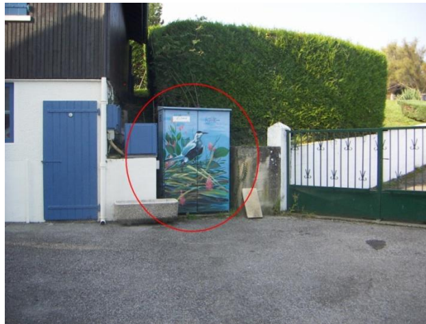
Figure 52 : Poste de relevage de Bellevue (Source: photo SERTE)
