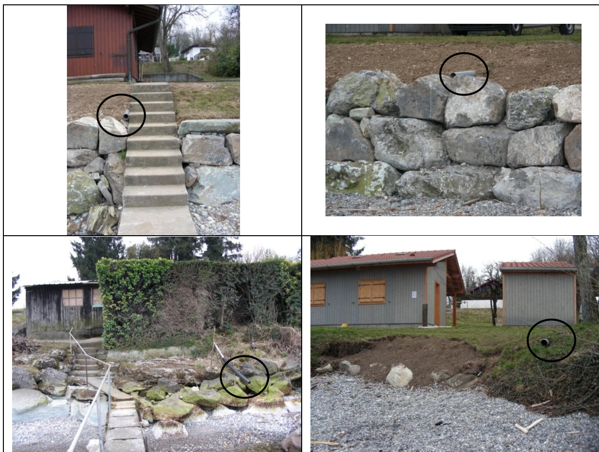
Figure 45 : Rejets d'eaux pluviales sur la zone de baignade (Source: photos CIDEE)
