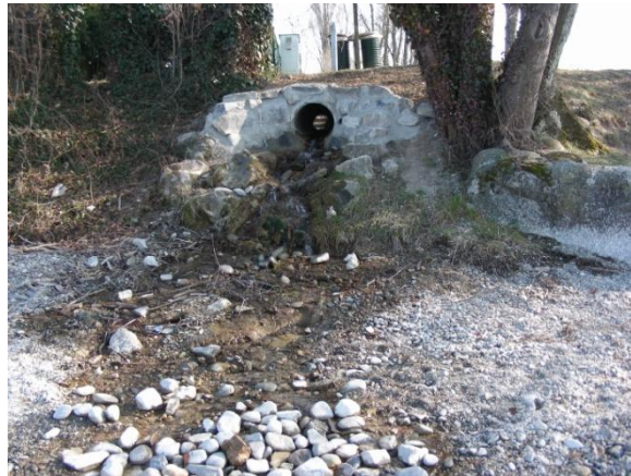
Figure 41 : Rejets d'eaux pluviales à proximité de l'exutoire des Fossaux et du poste de relevage Rive Ouest (Source: photo CIDEE)
