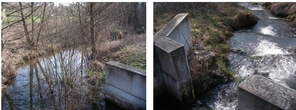
Figure 31 : La Gervonde au niveau de la prise d'eau de l'étang de Beau Soleil (Source: CIDEE)
