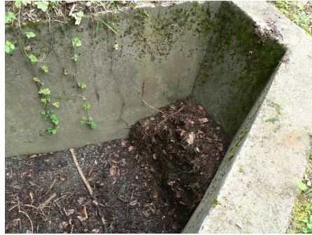
Colmatage d'une buse par des débris ligneux et des feuilles
