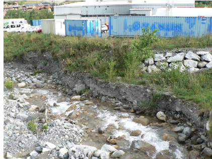
Erosions latérales en zone artisanale (torrent de Bonnegarde)
