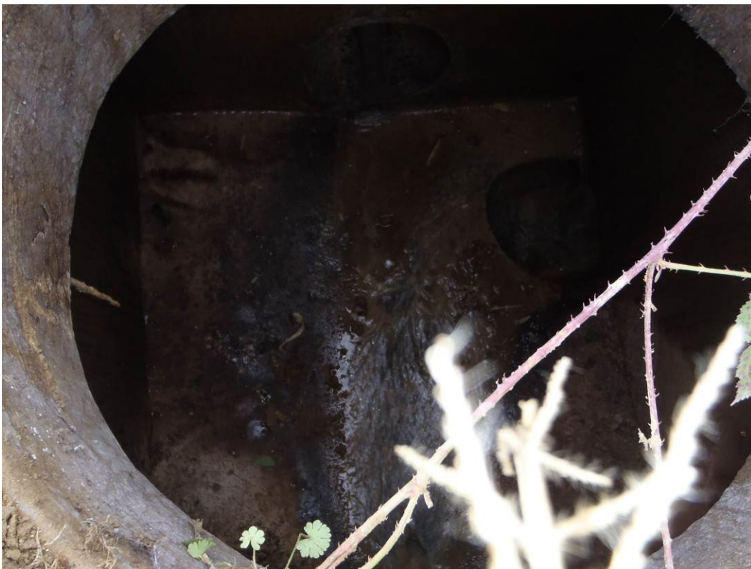
Photo n° 4 : Aperçu intérieur du déversoir d'orage du Village
