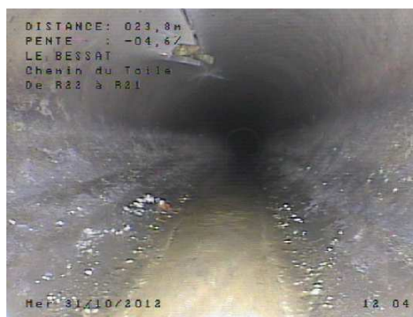
Rupture Chemin du Thoil : 21 à 22
