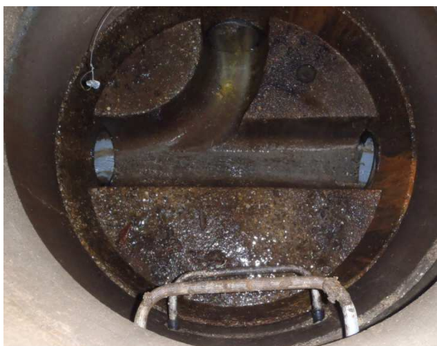
Suintement au droit du regard n°43
