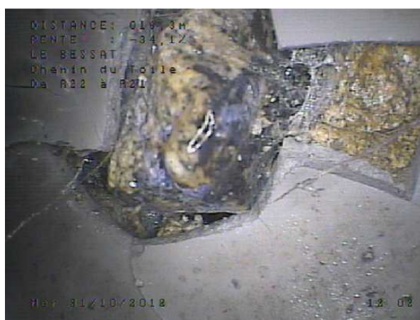
Rupture Chemin du Thoil : 21 à 22
