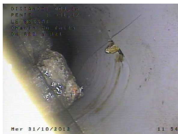
Fissure, paroi manquante, infiltration et dépôts Chemin du Thoile : 21 à 22
