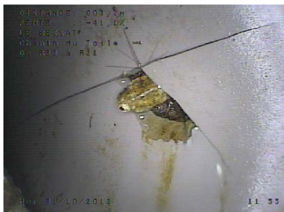
Fissure, paroi manquante, infiltration (zoom) Chemin du Thoil : 21 à 22
