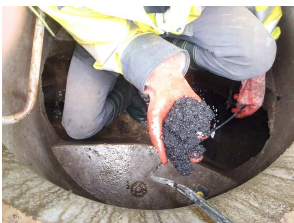
Présence de gravats (goudron) en quantité importante au droit du point 4 (Route de Tarentaise)
