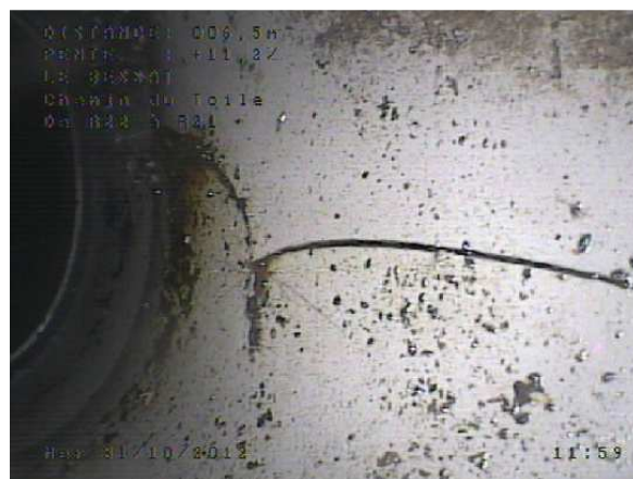
Fissure Chemin du Thoil : 21 à 22
