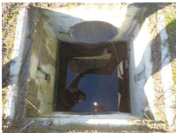
Trop-plein 1ere lagune avec détecteur de surverse
