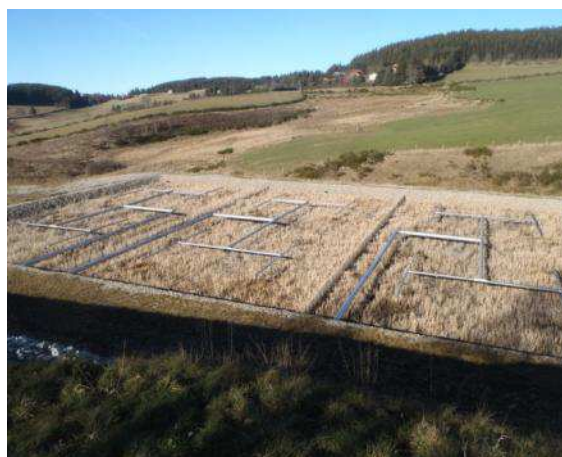
1er étage de filtres plantés de roseaux
