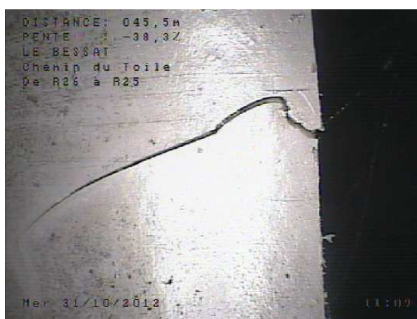
Fissures Chemin du Thoile : 25 à 26
