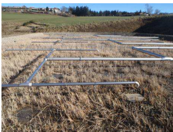
1er étage de filtres plantés de roseaux
