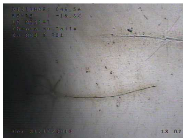
Fissure Chemin du Thoïl : 21 à 22
