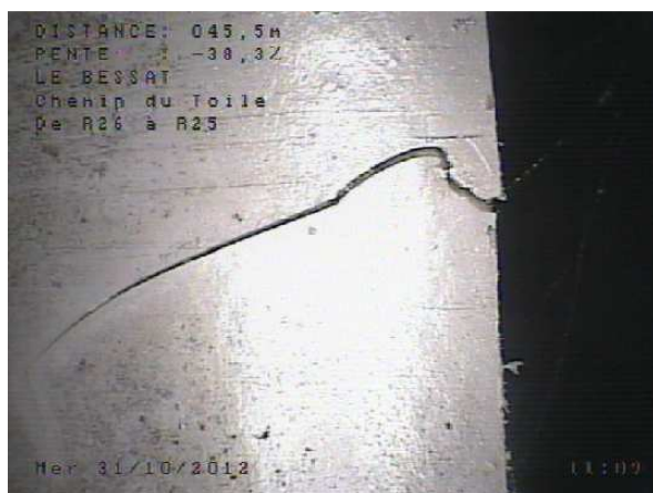
Fissures Chemin du Thoile : 25 à 26
