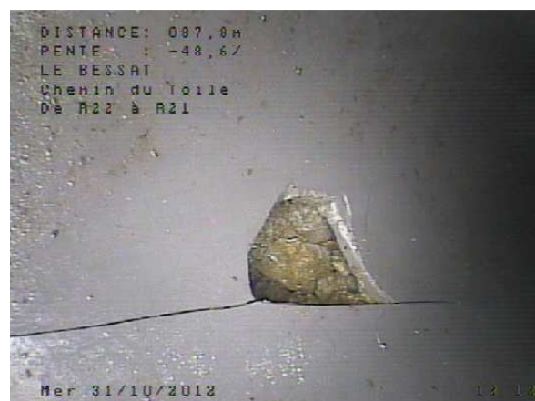
Rupture Chemin du Thoïl : 21 à 22
