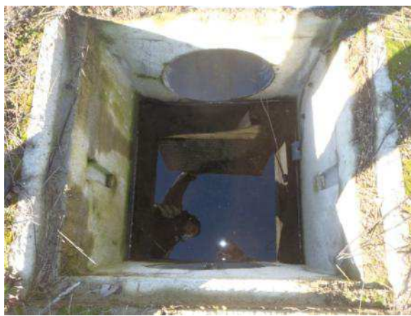
Trop-plein 1ere lagune avec détecteur de surverse
