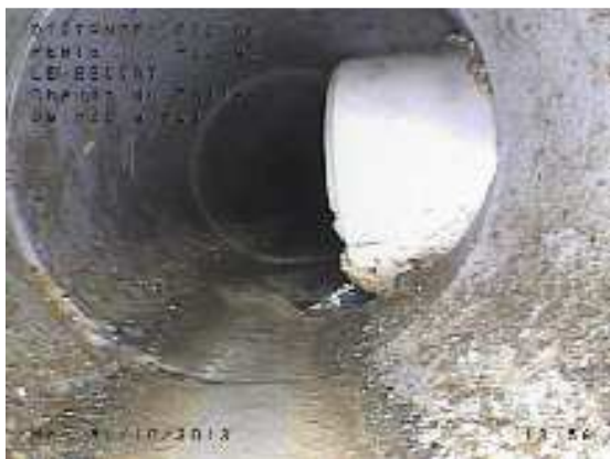
Branchement pénétrant et écoulement continu d'eau claire Chemin du Thoil : 21 à 19
