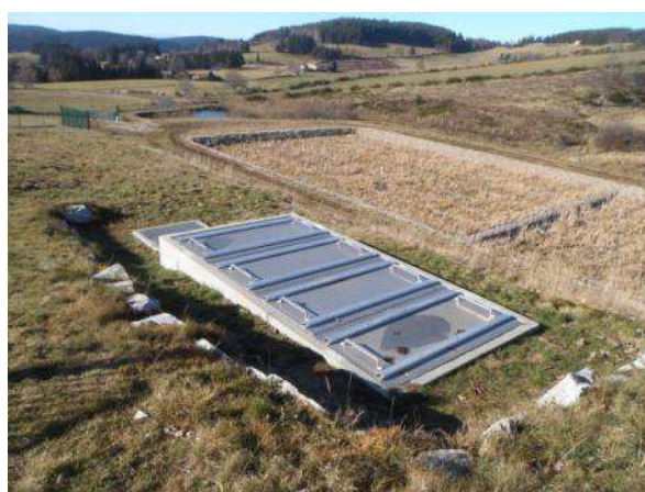
2e ouvrage de bâchées et 2 e étage de filtres plantés de roseaux
