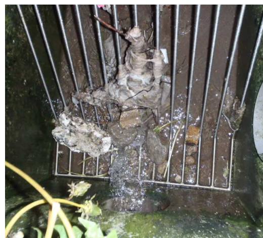
Présence de pierres au droit du dégrilleur
