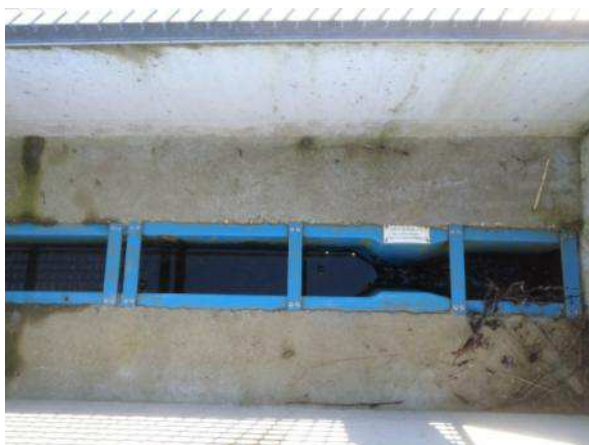
Canal Venturi – Sortie des filtres plantés de roseaux
