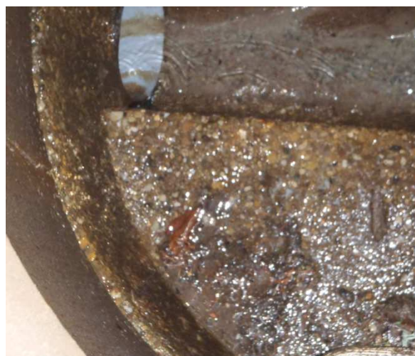
Suintement au droit du regard n°43
