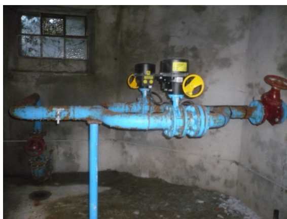
vannes motorisées (adduction du réservoir)
