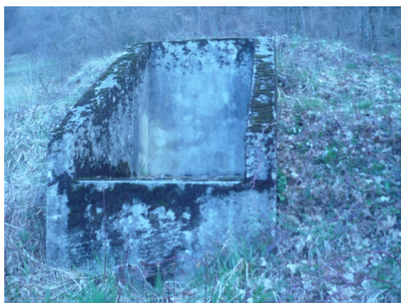
Réservoir des Granges
