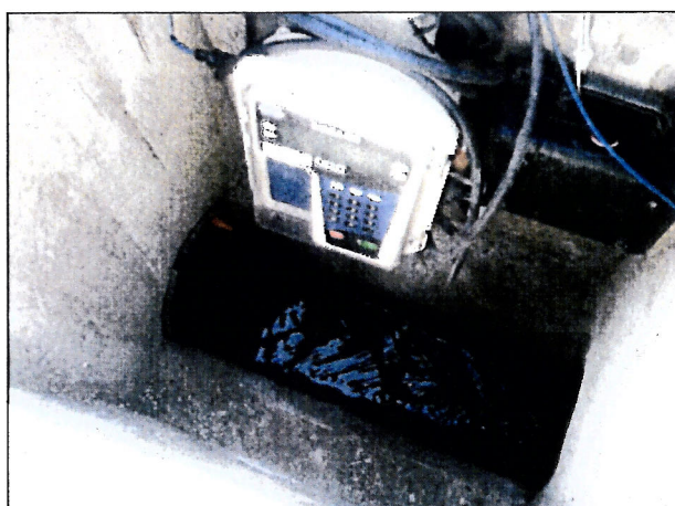
Débitmètre hauteur-vitesse au Point 3
