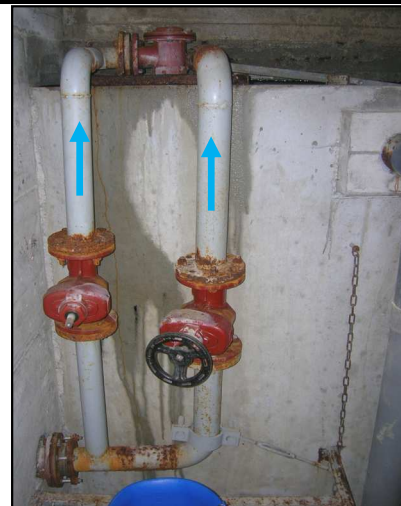
Adduction du réservoir
