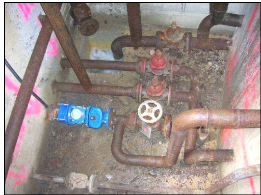
Photo 8 : Chambre de vannes – Réservoir du Struis
