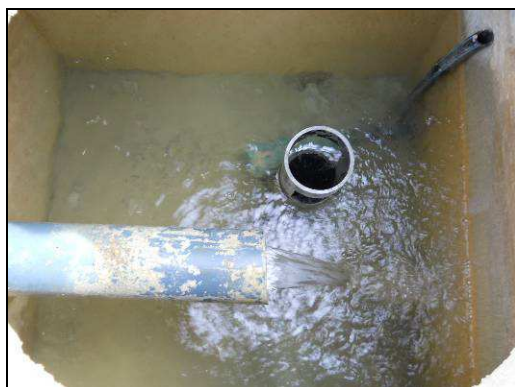
Photo 5 : Intérieur du regard de captage
