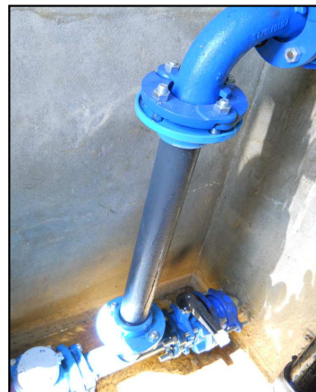
Interieur chambre de vannes - 1 -
