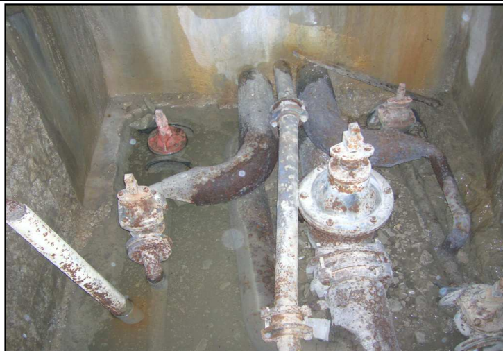
Chambre de vannes
