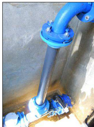
Photo 10 : Chambre de vannes – Réservoir du Savel
