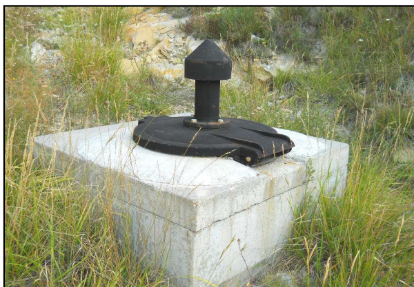
Tampon avec évent de l'ouvrage de captage
