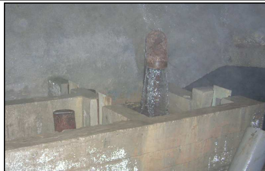
Adduction du réservoir
