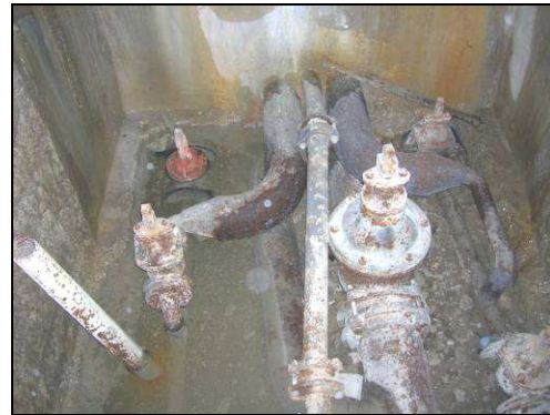
Photo 14 : Chambre de vannes – Réservoir du Village
