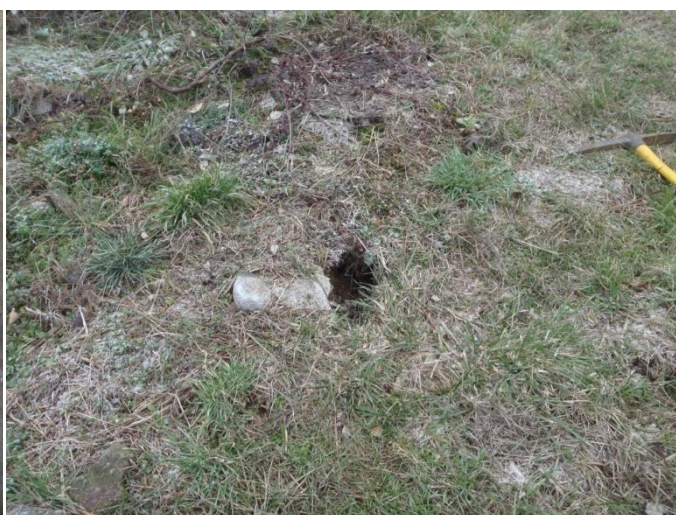
« Trou » à proximité du regard n°5
