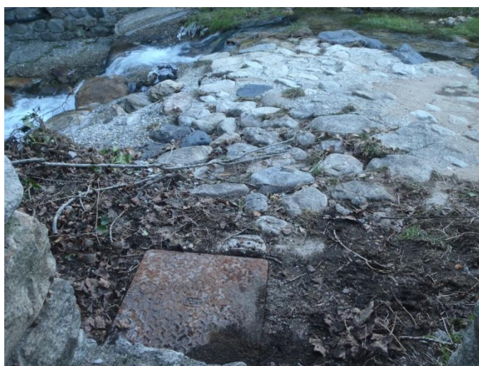
Tampon non étanche (regard n°38)
