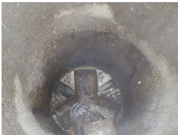
Infiltration par la cheminée et eaux claires parasites (Regard n°8)
