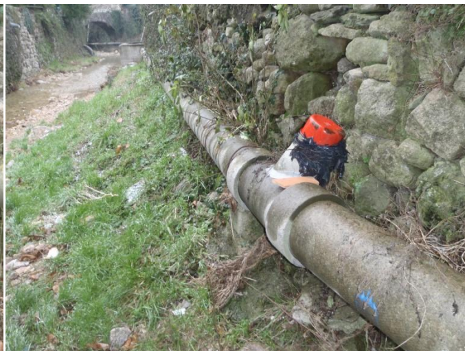
Té non étanche (tronçon 20-21)
