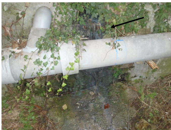
Rejet suspect (tronçon 20-21)
