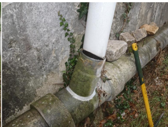
Raccordement non étanche (tronçon 20-21)
