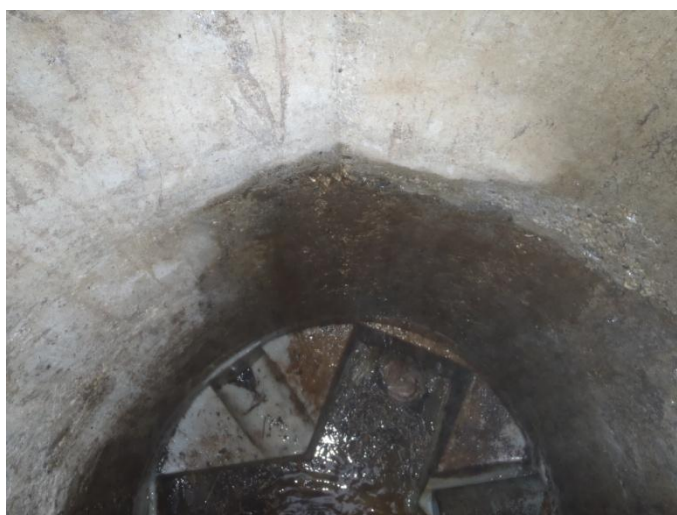
Infiltration par la cheminée (Regard n°5)
