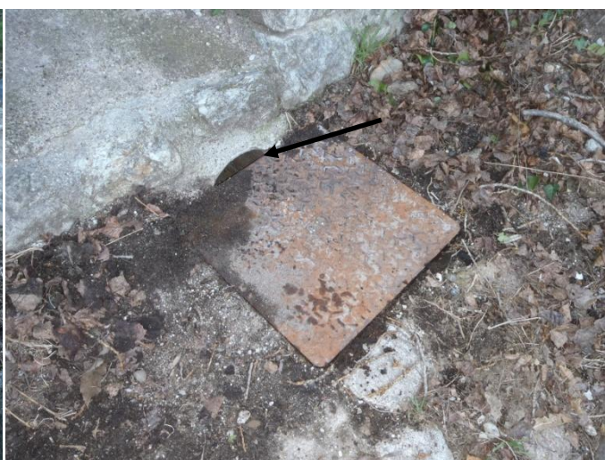
Tampon non étanche (regard n°38)
