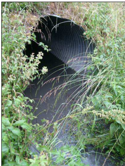
Photographie de l'un des busages assurant la continuité hydrologique du Vieux Gardon
