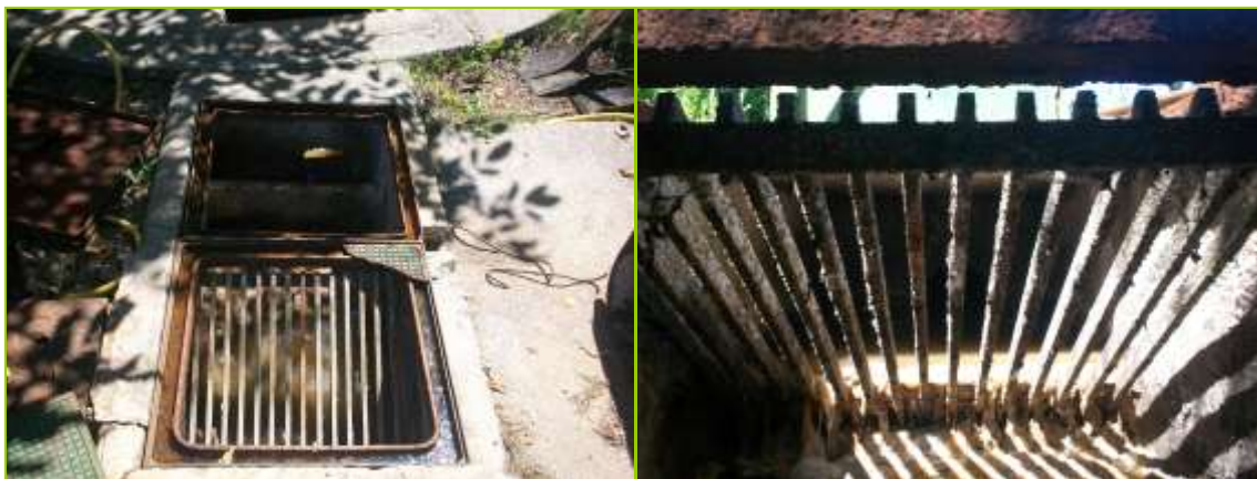
Illustration 2 : Le dégrilleur manuel
