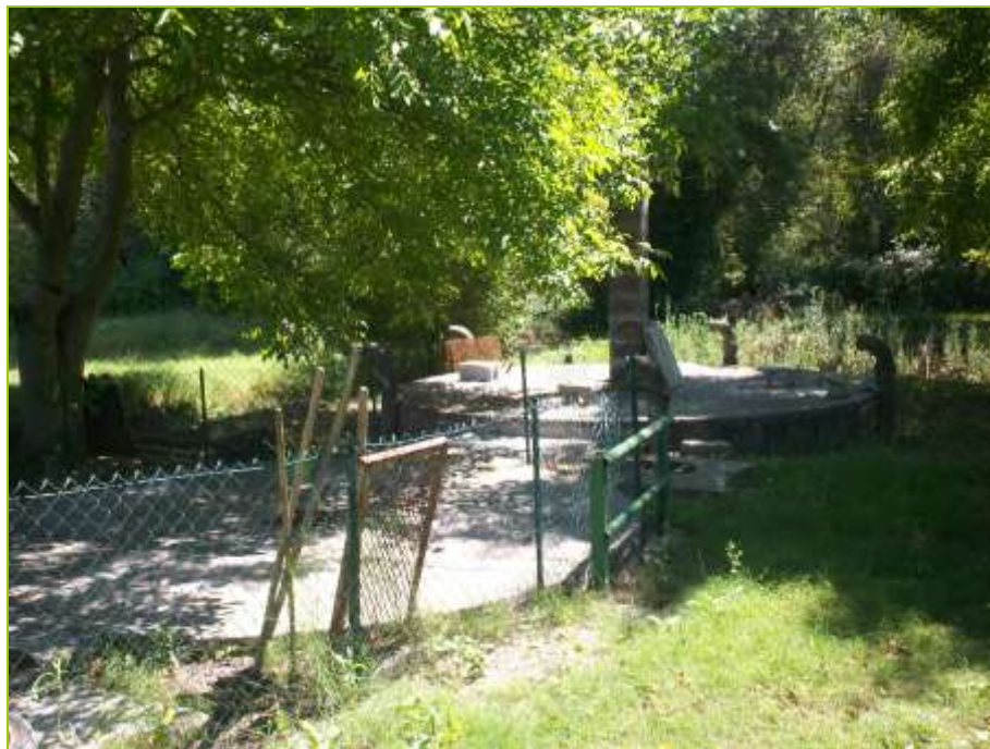
Illustration 1 : La station d'épuration de St Julien d'Asse
