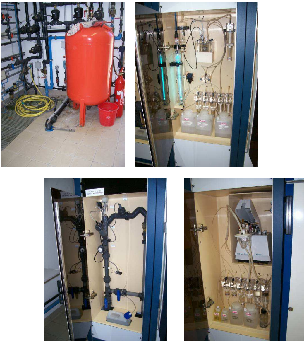
Figure 4 : Photos de la station d'alerte du Var (hydratec, juillet 2008)
