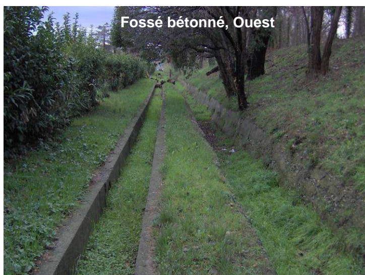
Figure 30 : Photos du réseau de drainage des Sagnes (Hydratec, 15/01/2008)
