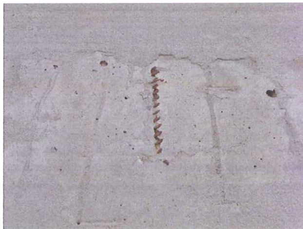
Fig. 5 : Absence d'enrobage en partie extérieure d'un voile du bassin
