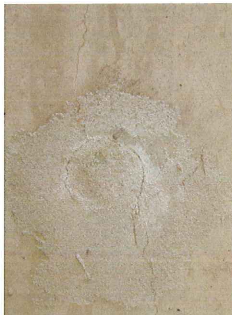
Fig. 7 : Fissure verticale au niveau d'un trou de banche en partie extérieure d'un voile du bassin
