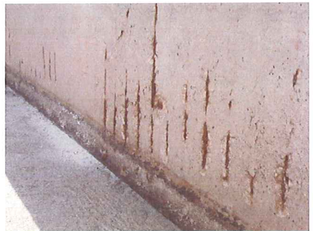
Fig. 3 : Eclats avec fers apparents au niveau du voile dans la goulotte (zone 2)
