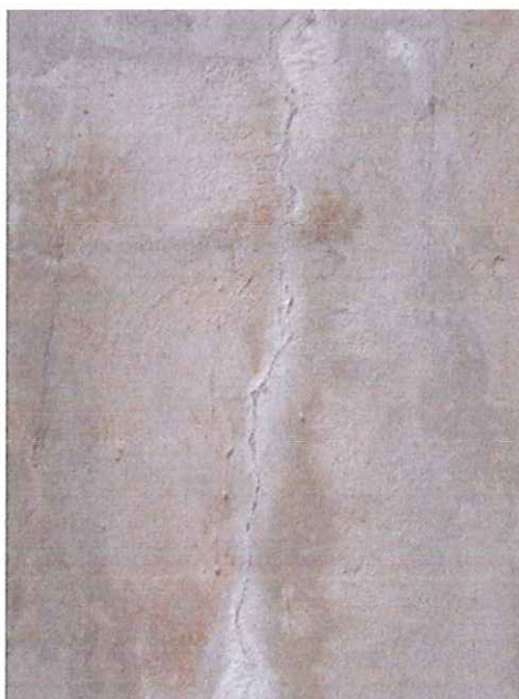
Fig. 6 : Fissure verticale avec efflorescence en partie extérieure d'un voile du bassin
