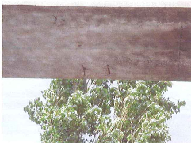
Fig. 4 : Eclats avec fers apparents en sous-face de la passerelle
