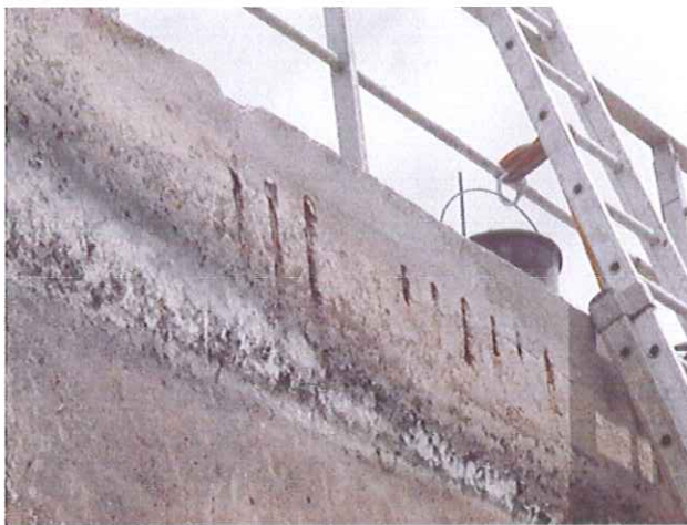
Fig. 2 : Eclats avec fers apparents en partie haute d'un voile, à l'intérieur du bassin (zone 1)
