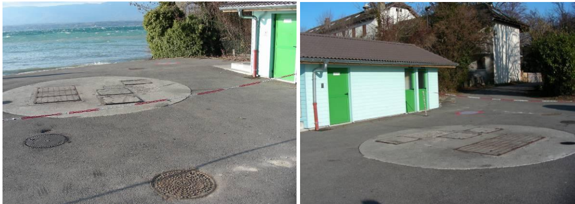
Figure 48 : Poste de refoulement de la zone de baignade de La Pointe (Source : photos CIDEE)
