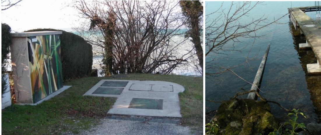
Figure 50 : Poste de refoulement de la Zone de baignade Municipale (à gauche) et son trop-plein (à droite) (Source : photos CIDEE)
