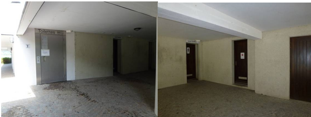
Figure 32 Sanitaires et douches présents sur le site
