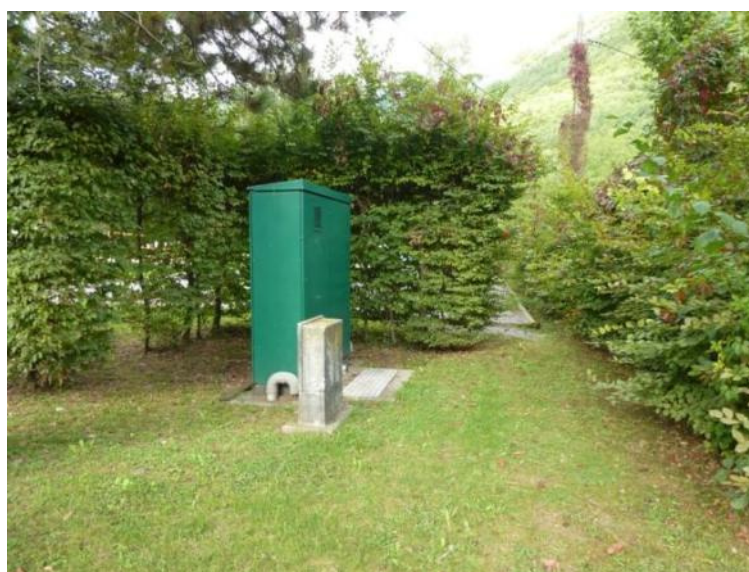
Figure 34 : station de pompage de la plage d’Angon (Source: photo CIDEE)
