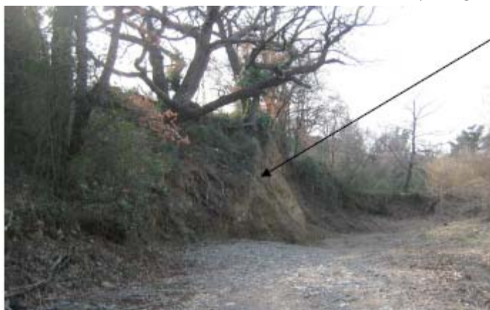
Érosion, déstabilisation d'arbres en rive droite
