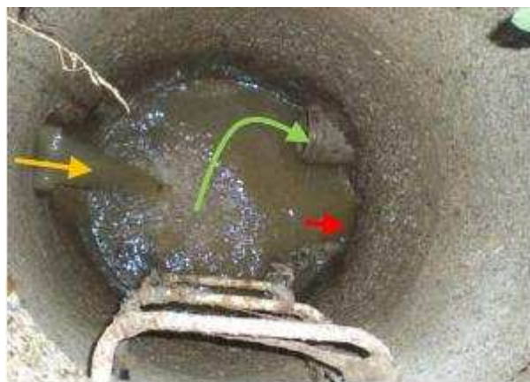
Figure 2-18 : Vue du DO50
