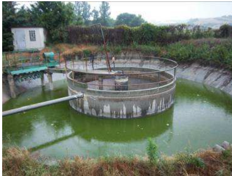
Figure 2-4 : Vue du bassin d'aération
