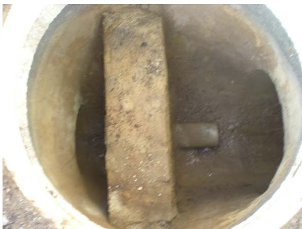
Figure 5-6 : ouvrage sur le réseau EP a Villette de Vienne
