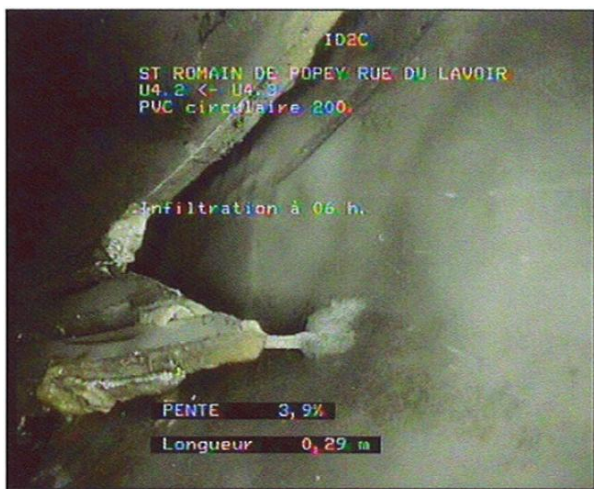
Infiltration sur regard, Rue du Lavoir
