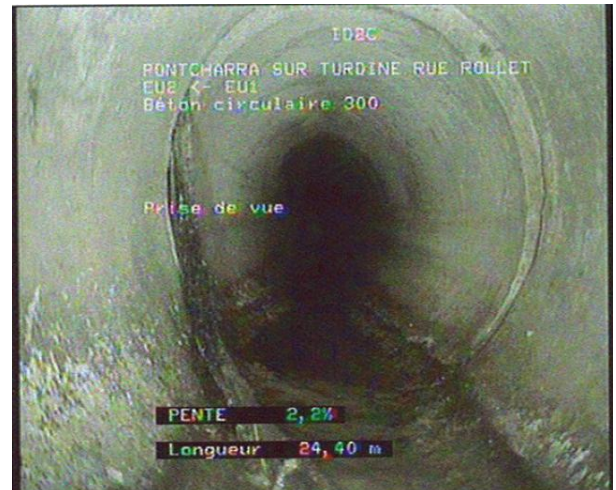
Joint défectueux Rue Rollet, Pontcharra-sur-Turdine
