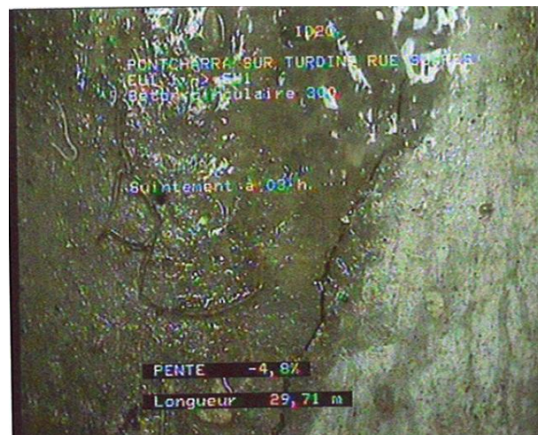
Suintement, Rue Suarès, Pontcharra-sur-Turdine
