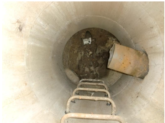
Absence de radier (Regard 215, gare de Pontcharra)
