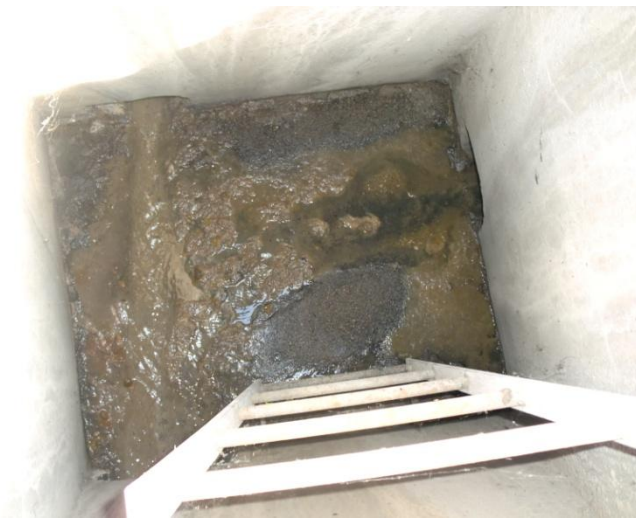
Absence de cunette et dépôts (Regard 184, rue Rollet, Pontcharra)
