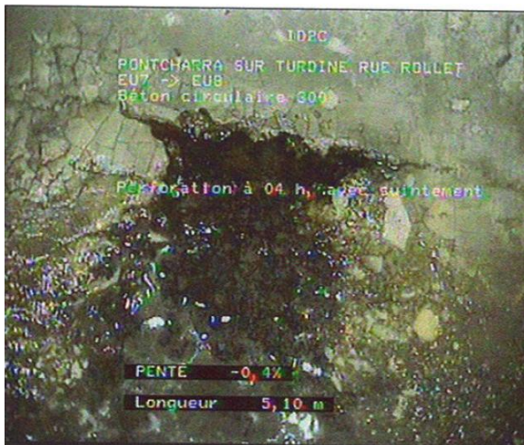
Perforation avec suintement, Rue Rollet, Pontcharra-sur-Turdine
