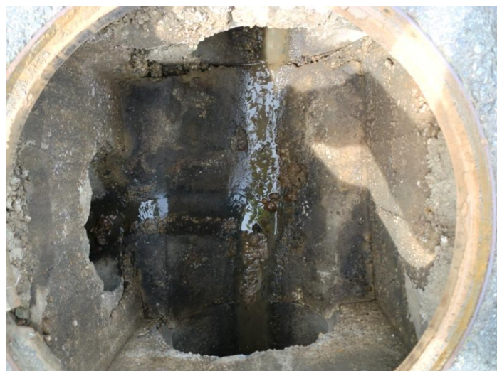
Mauvais état général (Regard 144, Bourg de Saint-Marcel)
