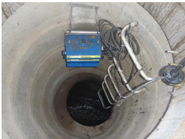
Déversoir d'orage amont
