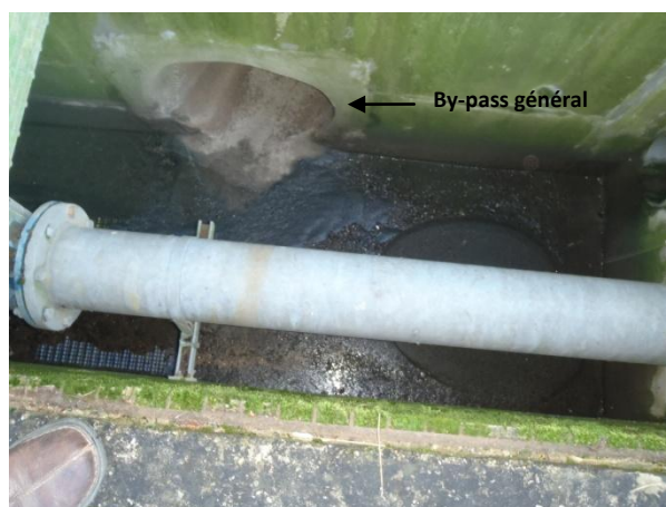
By-pass général de la station
