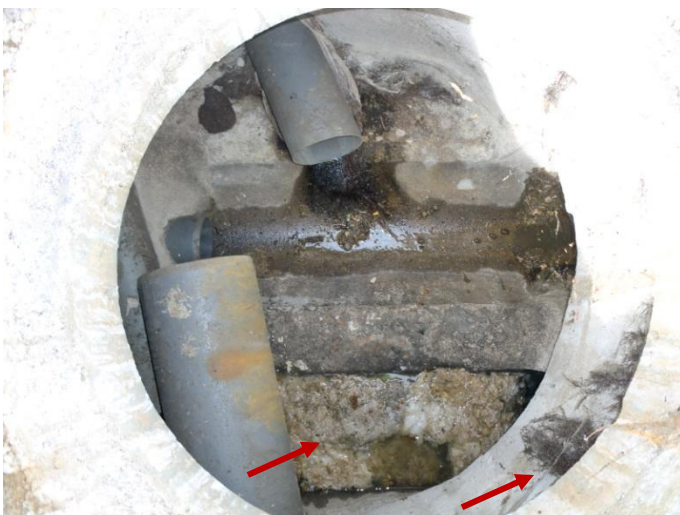
Dépôts, stagnation d'effluents, racines (Regard 196, rue Pasteur, Pontcharra)
