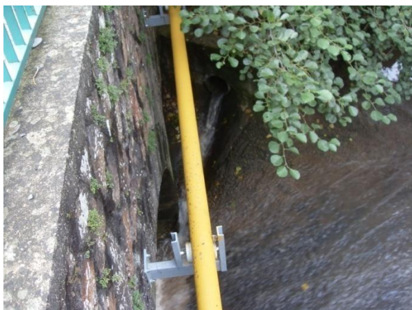
Rejet de la station
