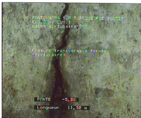
Fissure, Rue Suarès, Pontcharra-sur-Turdine
