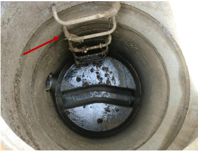
Traces mises en charge (Regard 119, amont DO3, St-Forgeux)
