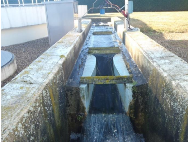
Canal Venturi (équipé)
