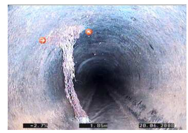
Perforation avec intrusion de racine Entre Rv32 et Rv67
