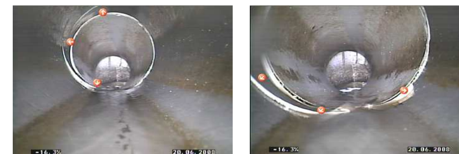
Fissure circulaire Entre Rv66bis et Rv66ter
