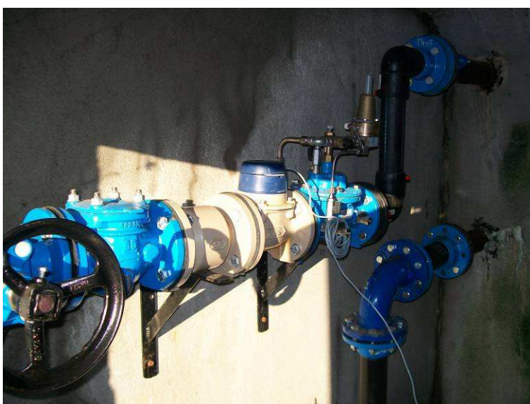
Réservoir du Villard / adduction
