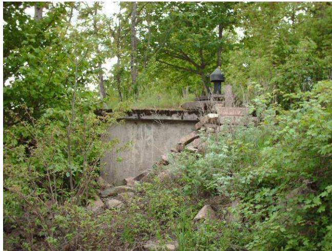
Réservoir de l'Echaillon / vue extérieure
