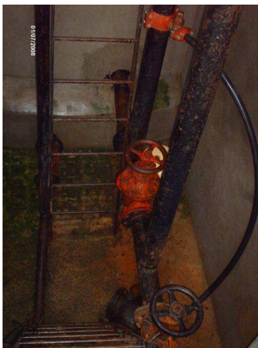
Réservoir de Sainte Luce / conduite d'adduction - distribution
