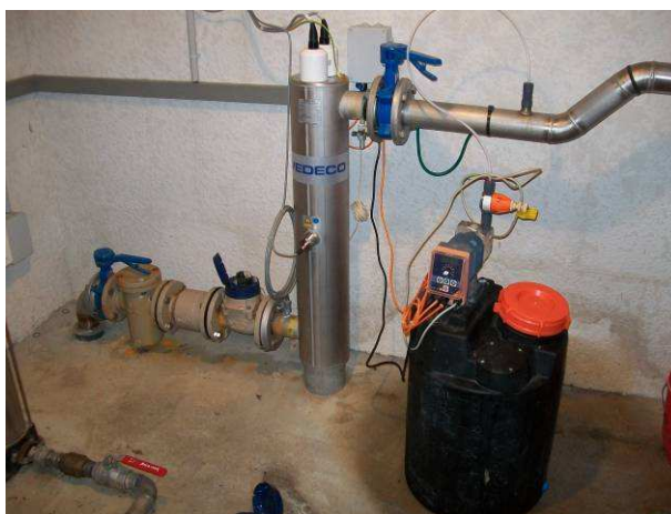
Station de pompage / systèmes de traitement
