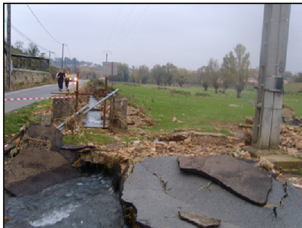
Dégâts sur la voirie dus à l'onde de rupture de la Galoche
