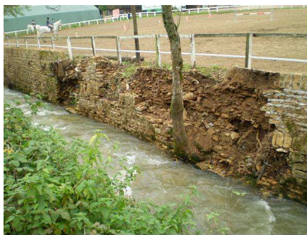
Dégâts le long du centre hippique au cours de la crue du 2 novembre 2008
