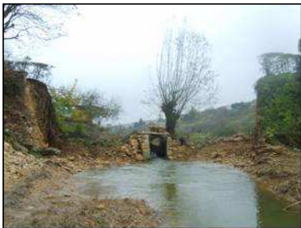
Brèche de la digue en travers sur la Galoche. L'ouvrage de passage est encore présent
