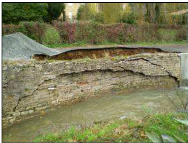
Dégâts occasionnés sur la berge rive gauche amont du lotissement « Le Nizerand » (2 novembre 2008)
