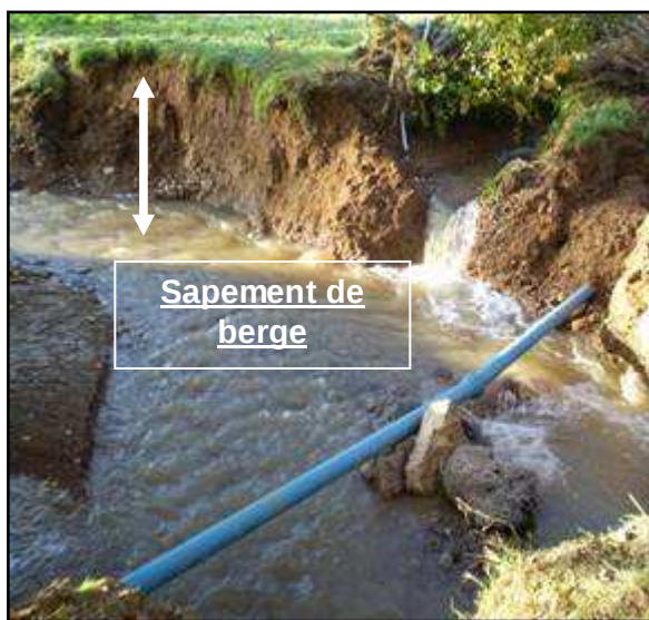
Sapement en amont de la commune avec rupture d'une canalisation AEP
