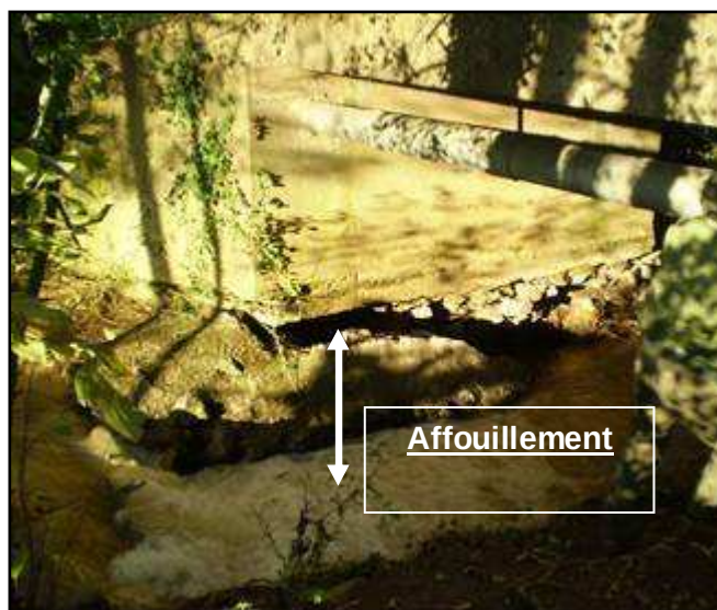
Affouillement de pont dans la plaine de Saint Julien en direction d'Arnas
