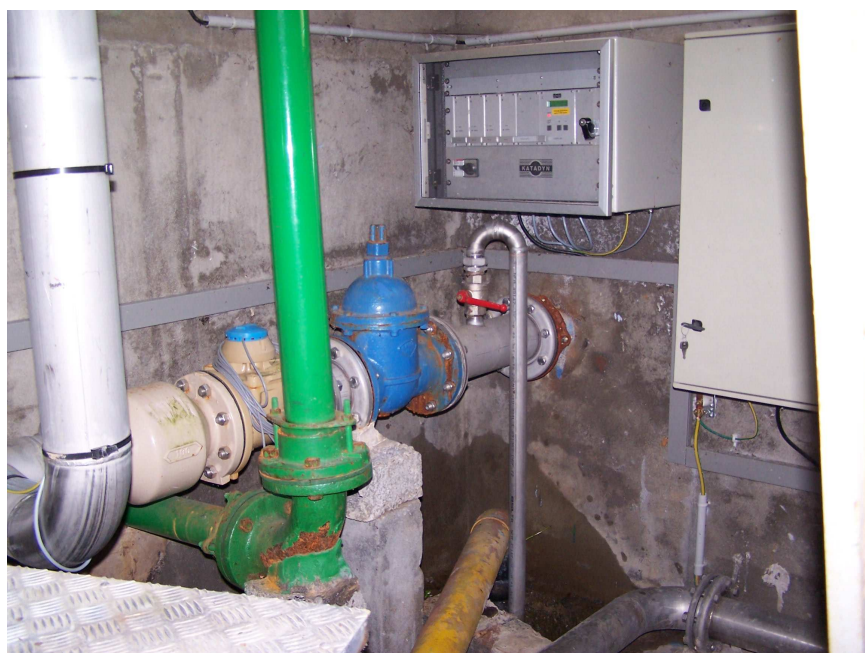
Photo n°2 : Vue partielle de la chambre des vannes : départ distribution
