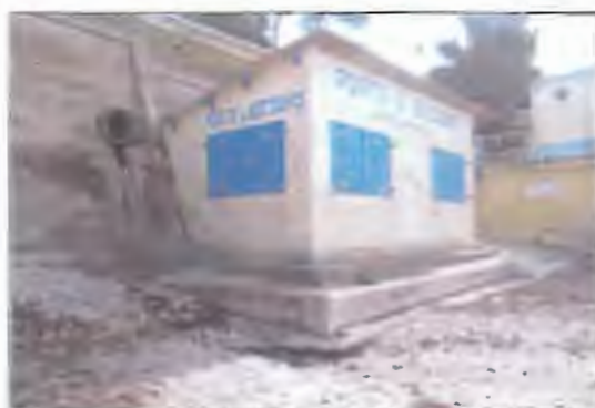
Figure 39 : Affouillement en pied de dalle du poste de secours (Plage du Lido / Sanary)
