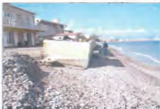
Figure 38 : Déstabilisation d'un mur en limite de propriété (Hyères Plage)
