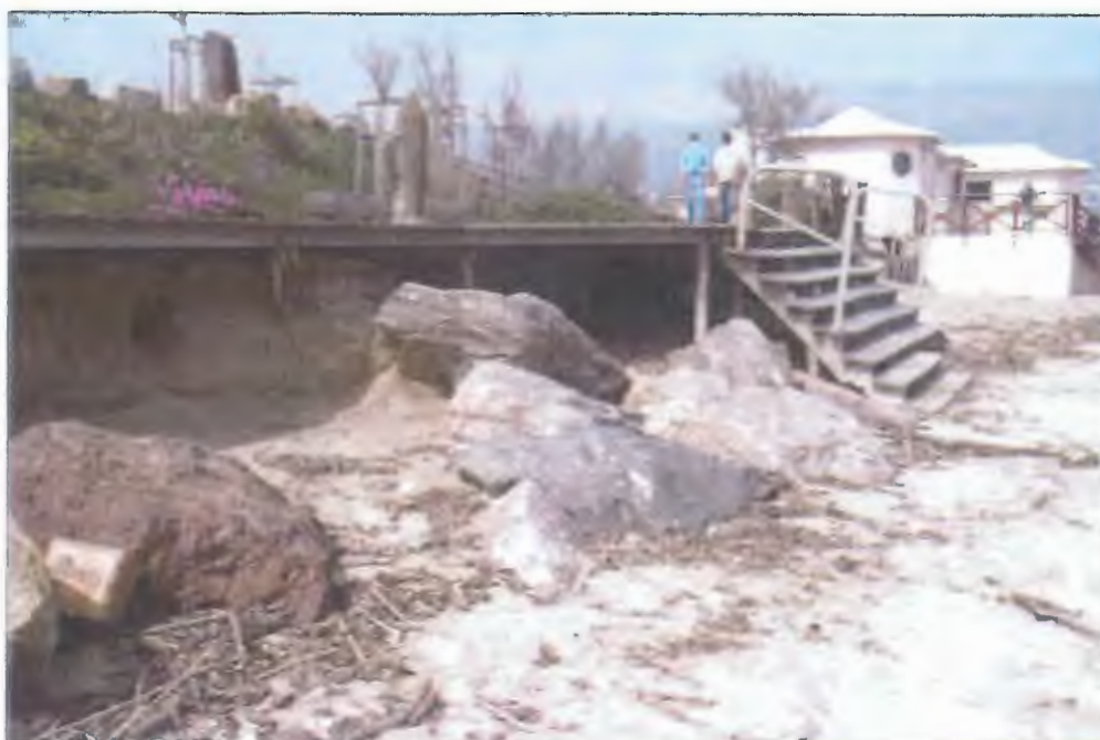
Figure 41 : Menace de déstabilisation de la promenade littorale (Le Lavandou)
