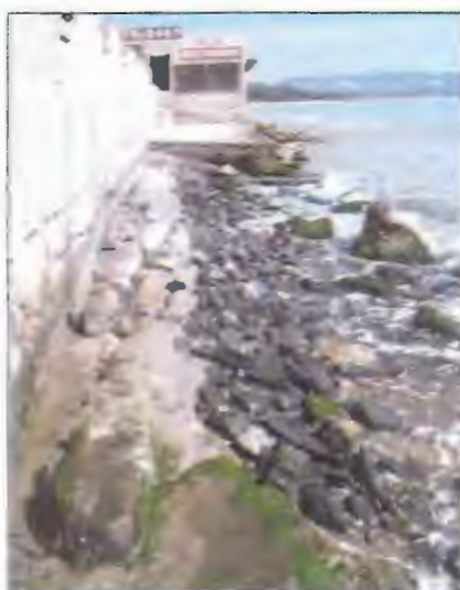
Figure 40 : Déstabilisation d'une terrasse en béton (Cavalaire)
