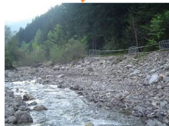
Photo 20 : Berge droite sapée supportant une piste
