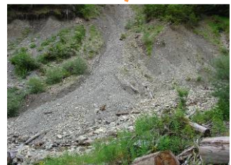
Photo 34 : Apport important en RD
