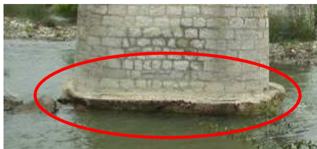
Figure 2-23 – déchaussement de pont à Lanas – Auzon
