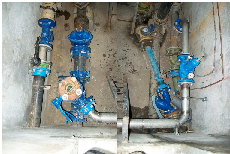
Vue intérieure - Réservoir du Chêne
