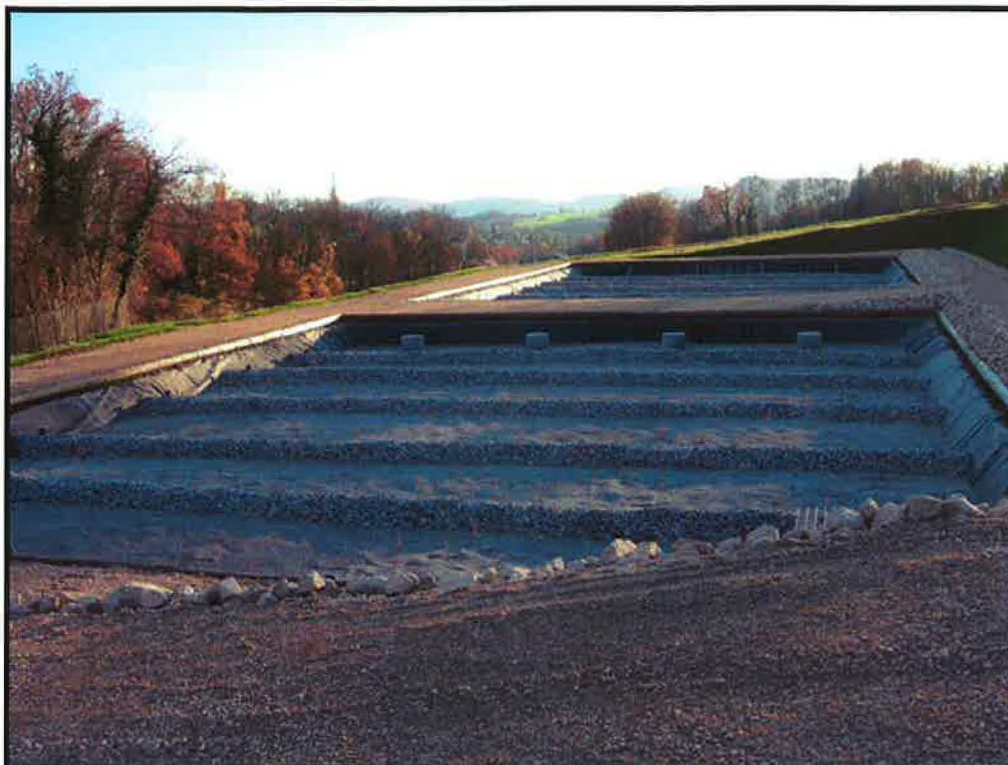
L'étage inférieur de la station
