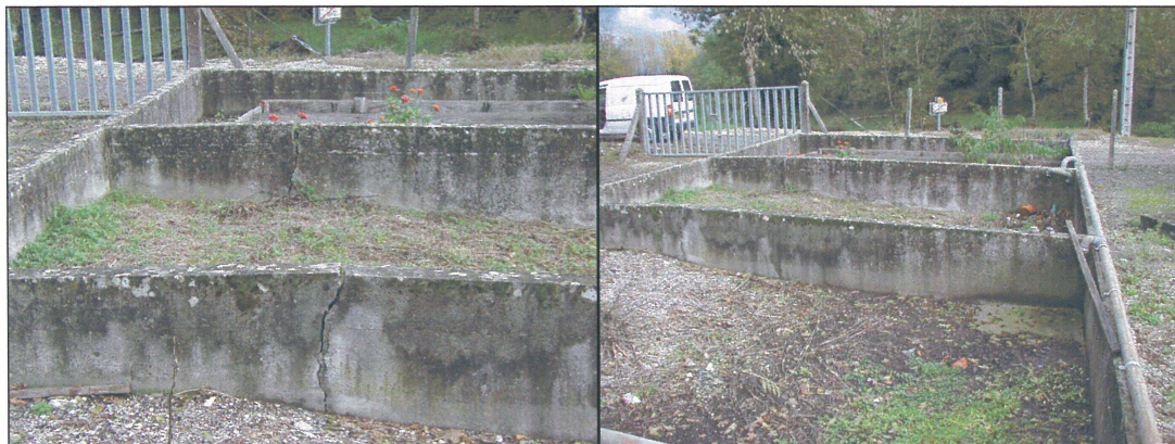
Photo n°4 et 5 : Lits de séchage des boues
