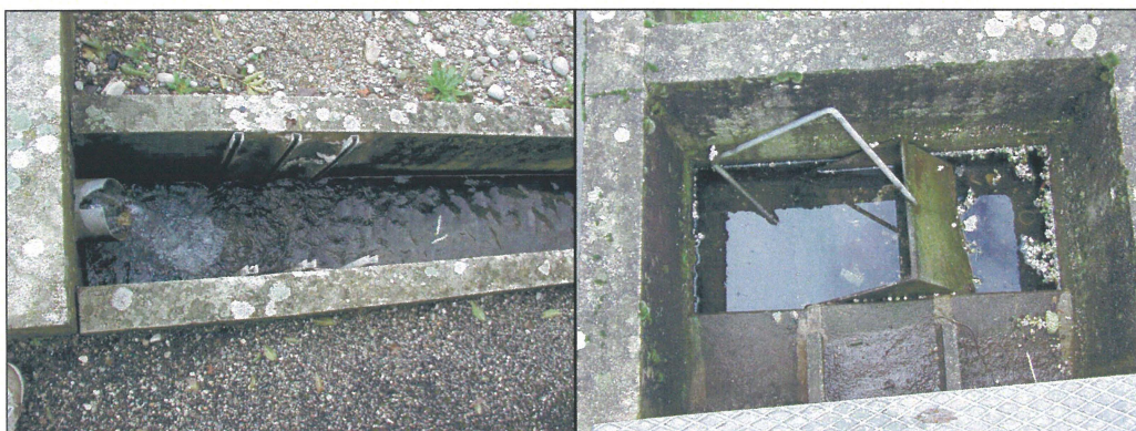
Photos n°1 et 2 : canal de mesure et dégrilleur
