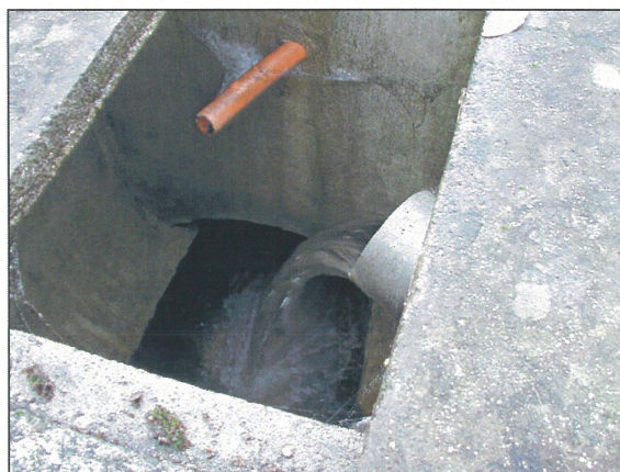
Photo n°6 : Rejet de la station
