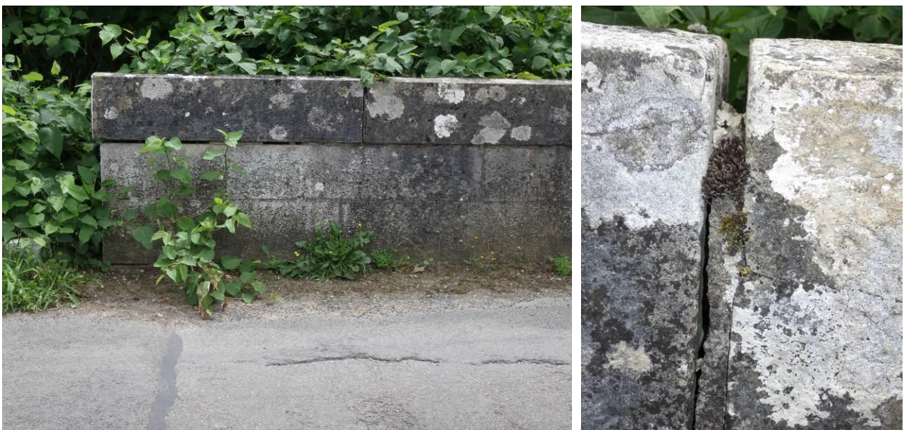
Figure 33 : Déstabilisation et déjointoiement des pierres du parapet côté rive gauche
