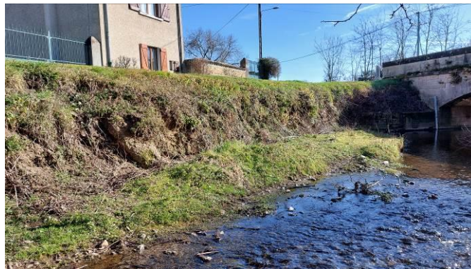
Figure 25 : Affaissement de la berge en amont de la rue du Lac
