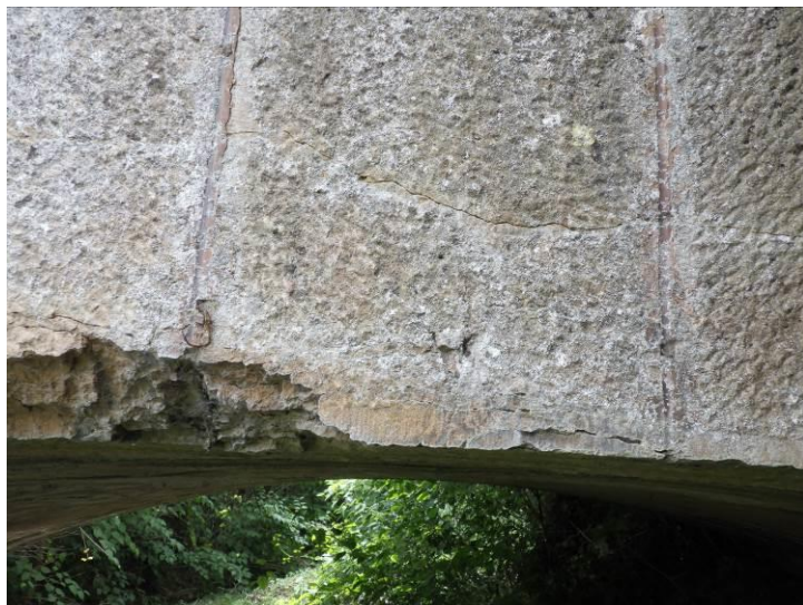
Figure 36 : Dégradation du parement côté amont
