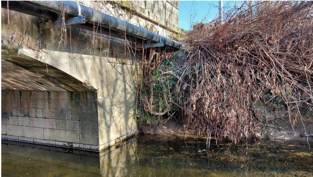
Figure 35 : Absence de protection de la berge en aval de la culée
