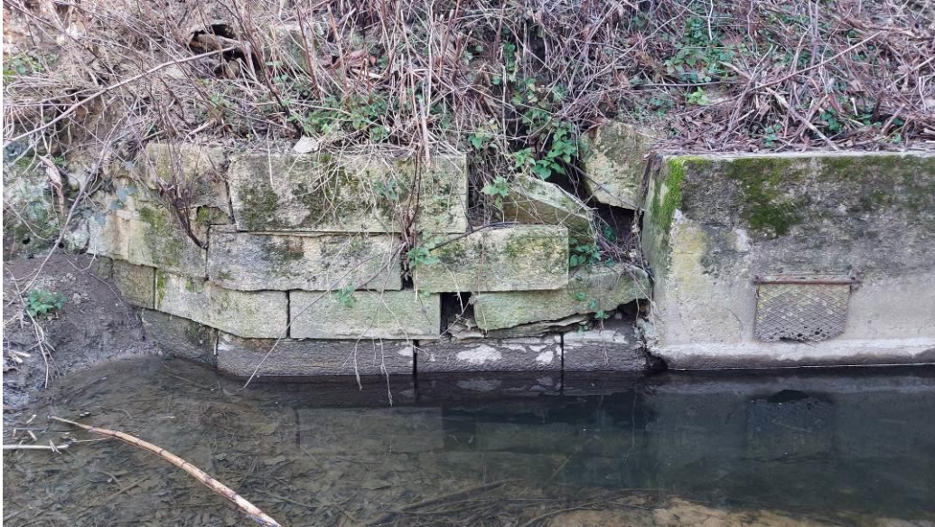
Figure 34 : Déstabilisation de la protection de la culée en amont du pont
