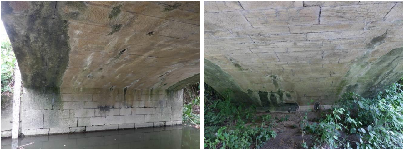
Figure 37 : Tâches d'humidité sur la voûte
