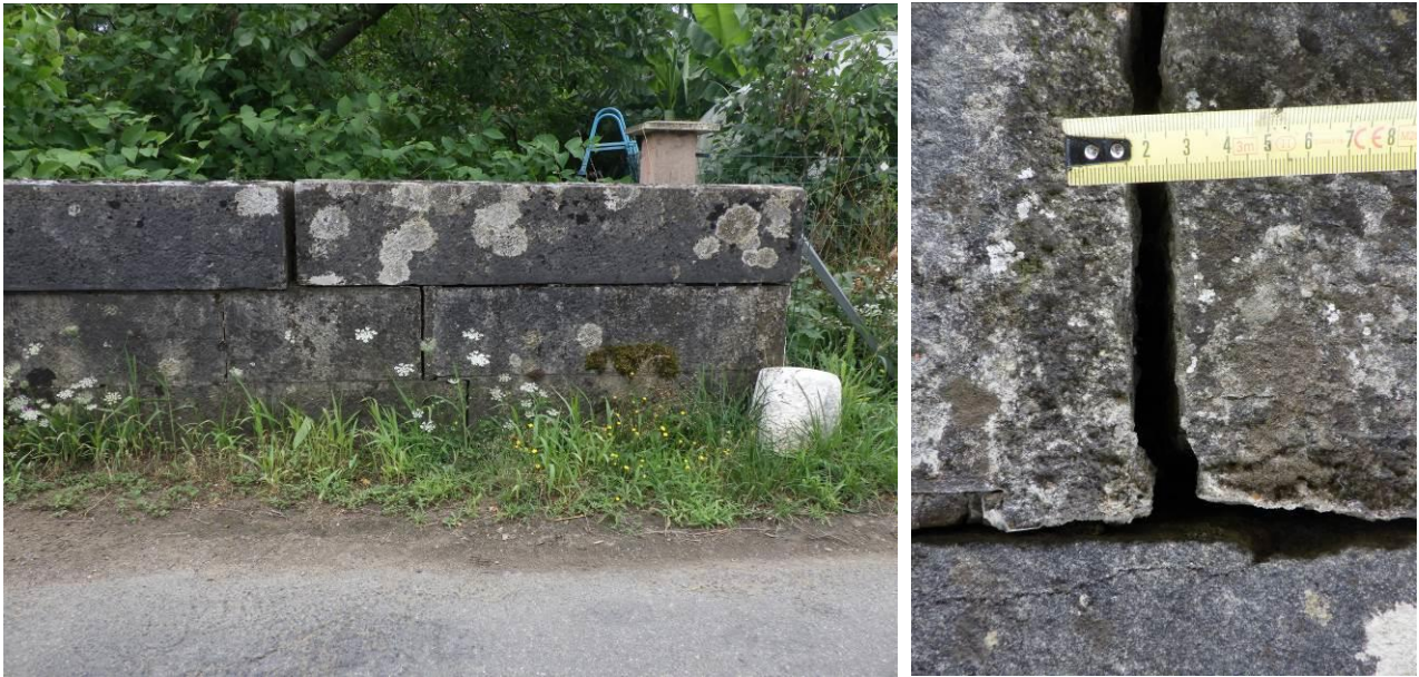
Figure 32 : Déstabilisation et déjointoiement des pierres du parapet côté rive droite
