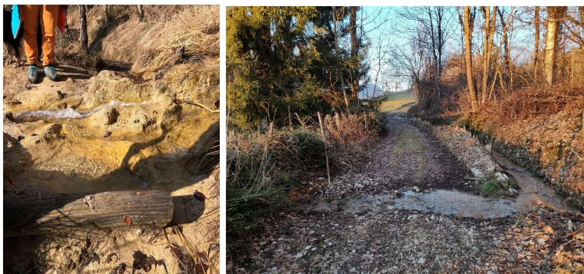
FIG.24 : DEGRADATION DES FORMATIONS DE TUF PAR EROSION ET TRAVERSEE DU CHEMIN PAR LE COURS D'EAU (PHOTO M. DE GROOT ET M. PANTALACCI)
