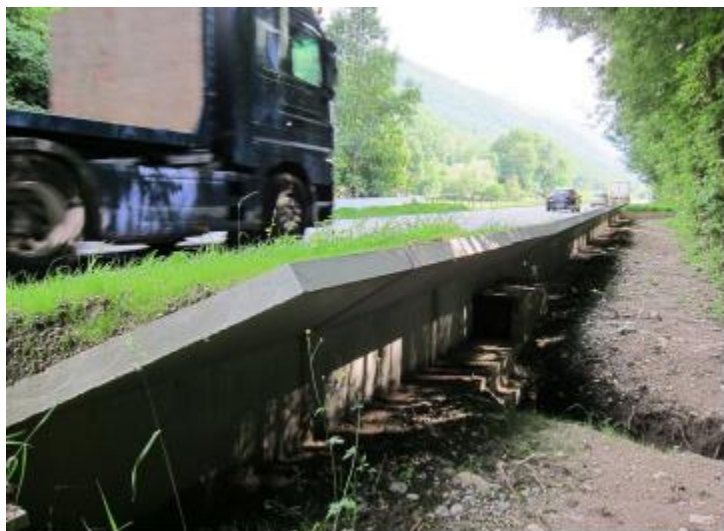
Passage à faune du Cheylas (département de l'Isère) avec vue sur le collecteur en L et son bavolet (A.Daloz-ATEN)
