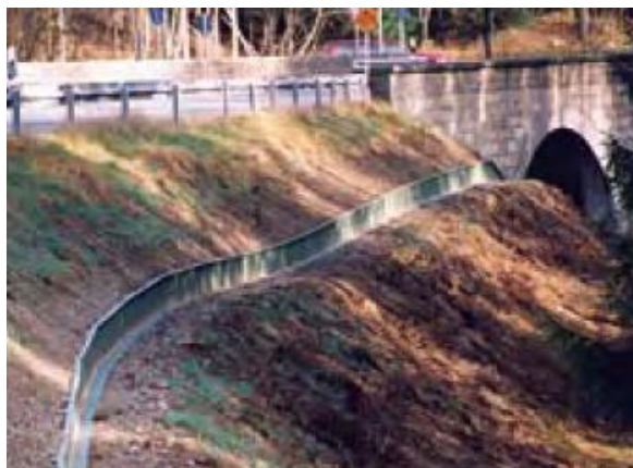
Figure 6 – Exemple de barrière pour amphibien (en Allemagne) avec talus au dos de celle-ci permettant à la faune de sortir de la voirie
