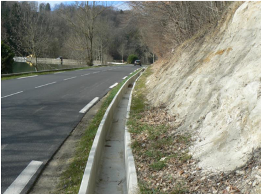
Figure 7 – Exemple de collecteur en U à l'étang de Bonne famille avec talus pentu (source : © Conseil départemental de l'Isère).
