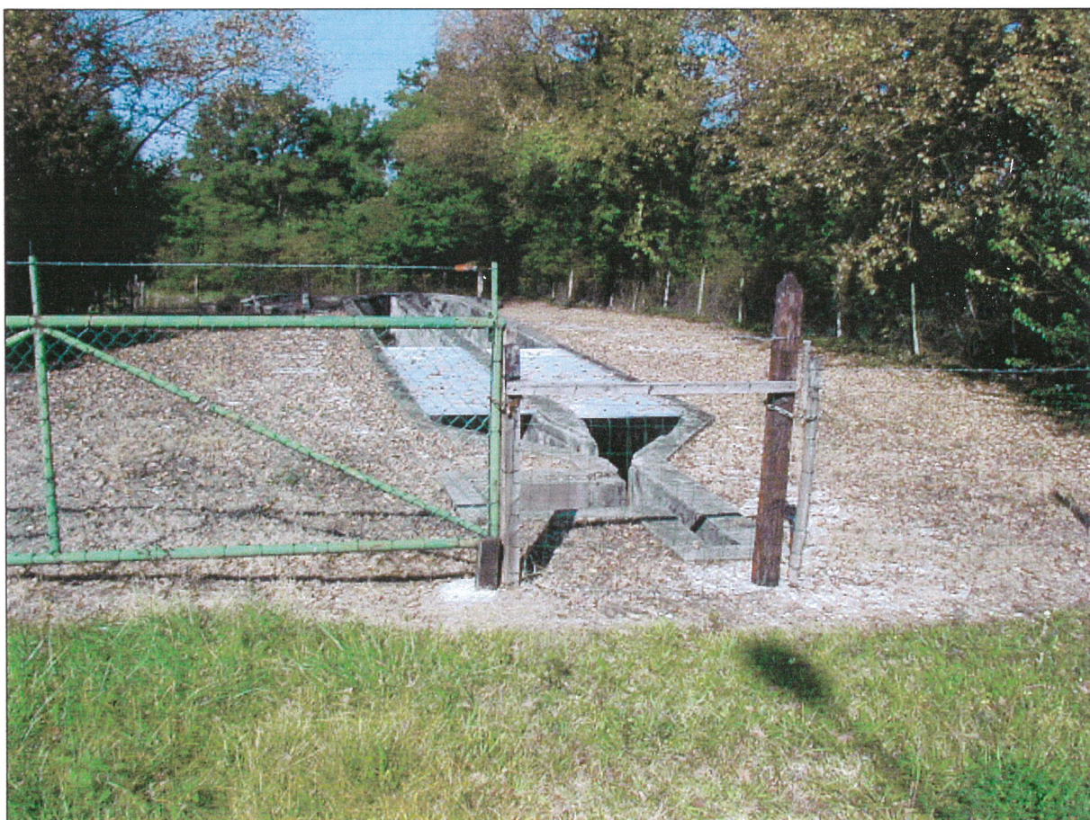
Décanteur digesteur de Tignieu
