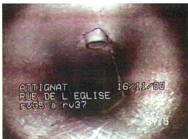
Fig. 2-c : Exemple de branchement pénétrant (anomalie fonctionnelle)
