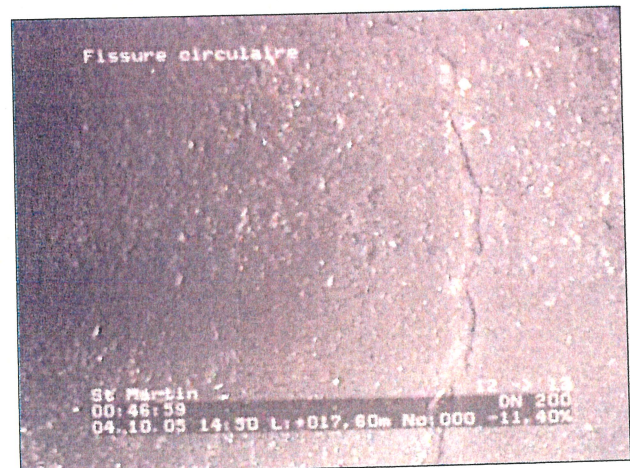
Photo: 9_5a, N° cassette: 1, 00:46:58 17,6m, Fissure circulaire
