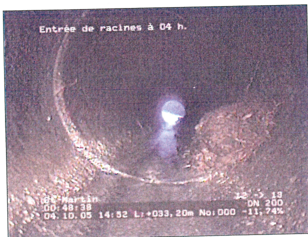
Photo: 9_8a, N° cassette: 1, 00:48:37 33,2m, Entrée de racines à 04 h.
