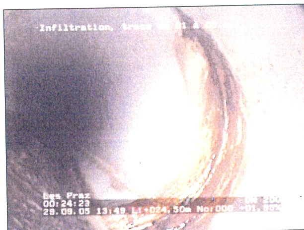
Photo: 3_7a, N° cassette: 1, 00:24:22 24,5m, Infiltration, trace de 01 à 05 h.
