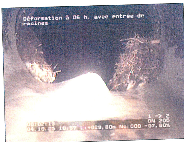
Photo: 1_3a, N° cassette: 1, 00:02:10 29,8m, Déformation à 06 h. avec entrée de racines
