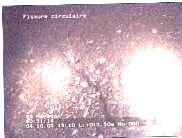
Photo: 10_5a, N° cassette: 1, 00:51:13 15,5m, Fissure circulaire
