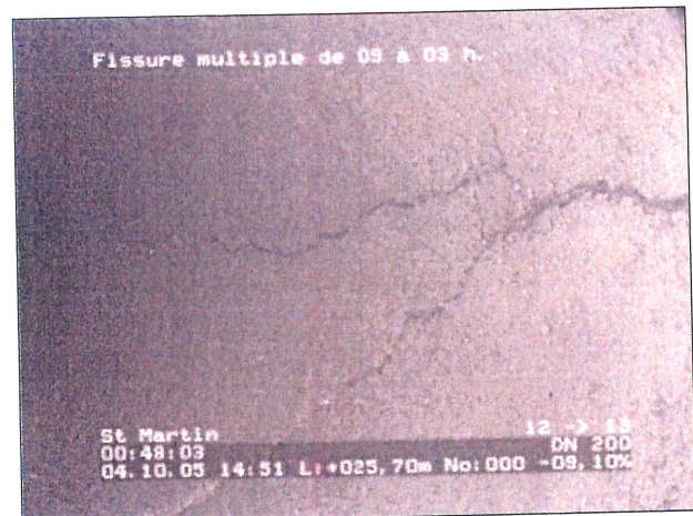
Photo: 9_7a, N° cassette: 1, 00:48:00 25,7m, Fissure multiple de 09 à 03 h.
