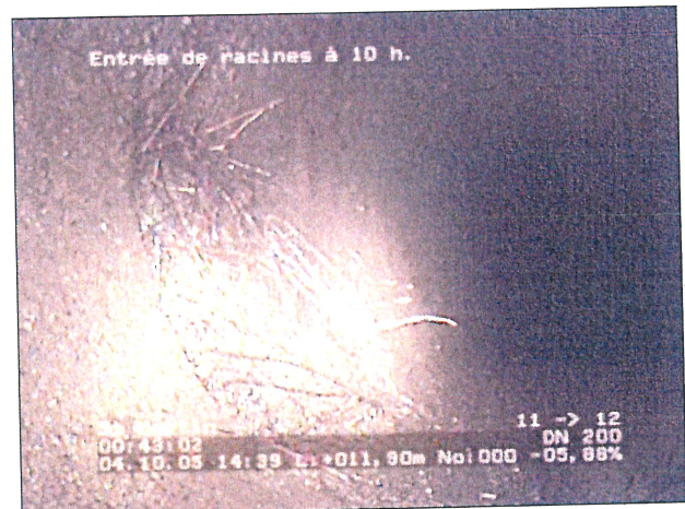
Photo: 8_3a, N° cassette: 1, 00:43:00 11,9m, Entrée de racines à 10 h.
