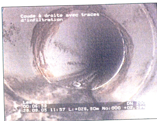
Photo: 2_5a, N° cassette: 1, 00:06:55 28,9m, Coude à droite avec traces d'infiltration
