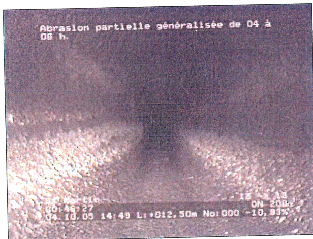
Photo: 9_4a, N° cassette: 1, 00:46:24 12,5m, Abrasion partielle généralisée de 04 à 08 h.
