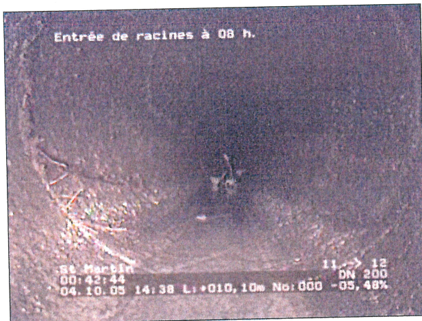
Photo: 8_2a, N° cassette: 1, 00:42:41 10,1m, Entrée de racines à 08 h.
