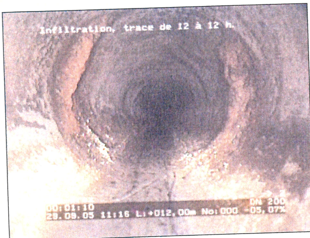
Photo: 1_2a, N° cassette: 1, 00:01:05 12m, Infiltration, trace de 12 à 12 h.
