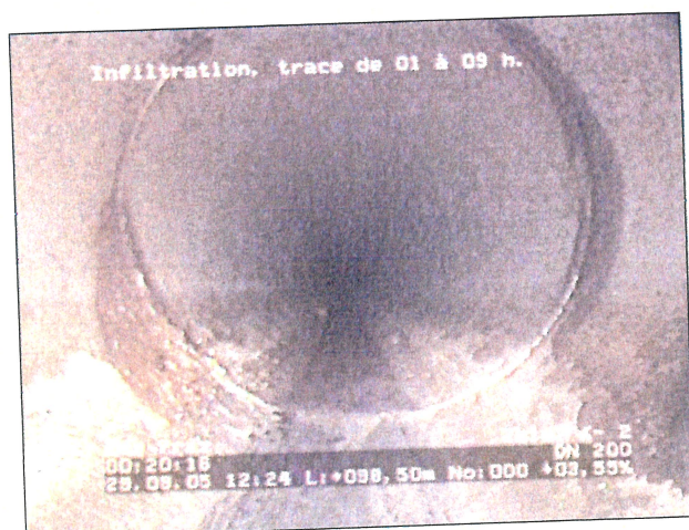
Photo: 2_12a, N° cassette: 1, 00:20:16 98,5m, Infiltration, trace de 01 à 09 h.
