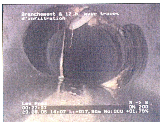
Photo: 4_9a, N° cassette: 1, 00:27:55 17,9m, Branchement à 12 h. avec traces d'infiltration
