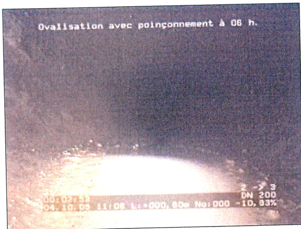
Photo: 2_2a, N° cassette: 1, 00:02:50 0,9m, Ovalisation avec poinçonnement à 06 h.
