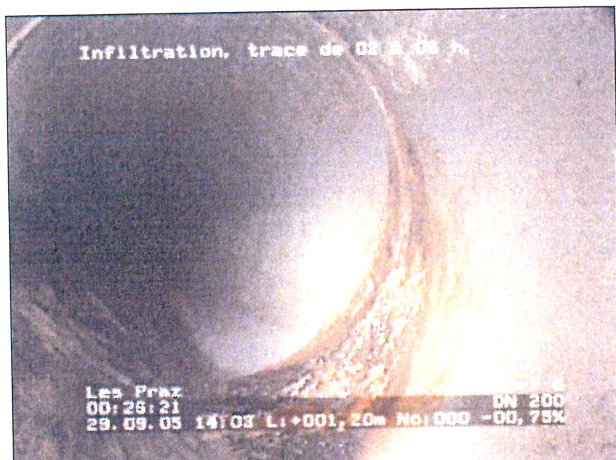
Photo: 4_2a, N° cassette: 1, 00:26:20 1,2m, Infiltration, trace de 02 à 06 h.
