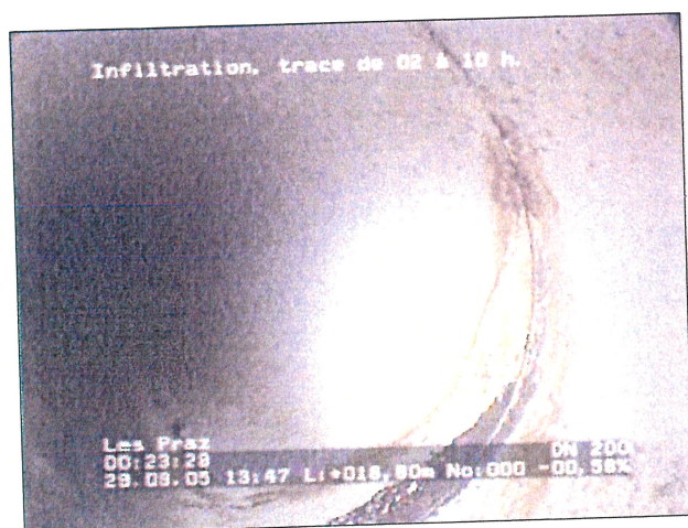
Photo: 3_4a, N° cassette: 1, 00:23:27 18,8m, Infiltration, trace de 02 à 10 h.
