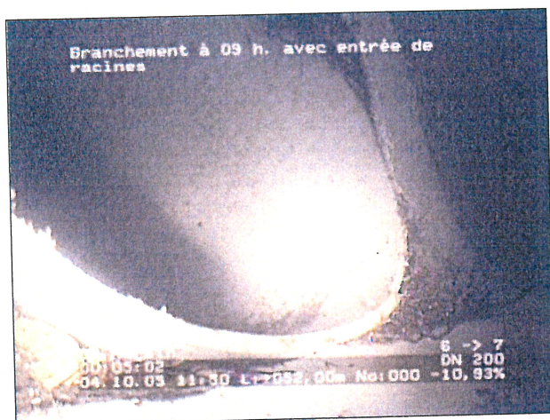
Photo: 4_6a, N° cassette: 1, 00:04:59 52m, Branchement à 09 h. avec entrée de racines
