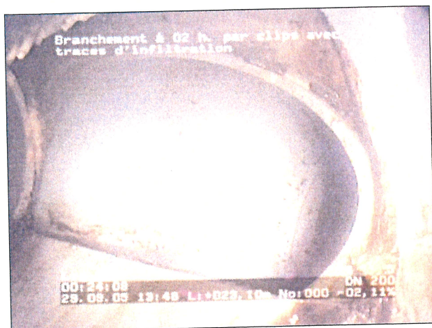
Photo: 3_6a, N° cassette: 1, 00:24:06 23,1m, Branchement à 02 h. par clips avec traces d'infiltration
