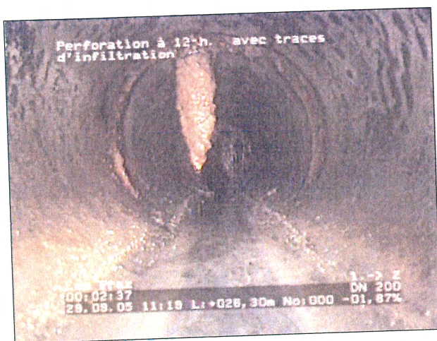
Photo: 1_4a, N° cassette: 1, 00:02:34 26,3m, Perforation à 12 h. avec traces d'infiltration
