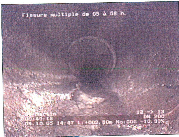
Photo: 9_2a, N° cassette: 1, 00:45:15 2,5m, Fissure multiple de 05 à 08 h.
