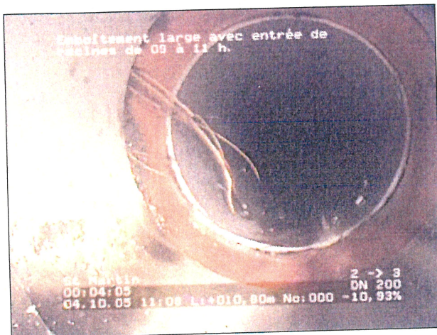
Photo: 2_4a, N° cassette: 1, 00:04:04 10,8m, Emboîtement large avec entrée de racines de 09 à 11 h.
