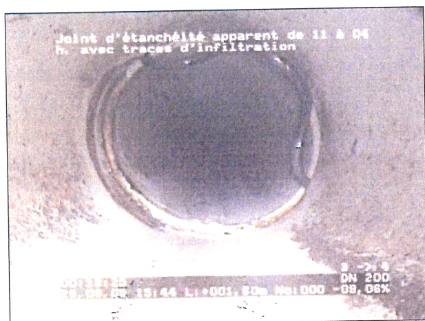
Photo: 3_2a, N° cassette: 1, 00:18:20 1,6m, Joint d'étanchéité apparent de 11 à 04 h. avec traces d'infiltration
