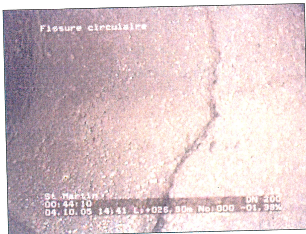
Photo: 8_4a, N° cassette: 1, 00:44:07 26,9m, Fissure circulaire
