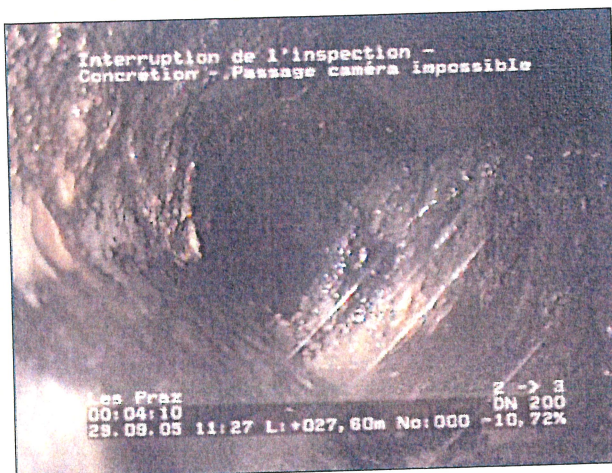
Photo: 1_7a, N° cassette: 1, 00:04:10 27,6m, Interruption de l'inspection - Concrétion - Passage caméra impossible
