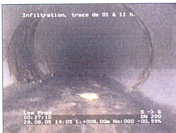
Photo: 4_6a, N° cassette: 1, 00:27:08 9m, Infiltration, trace de 01 à 11 h.
