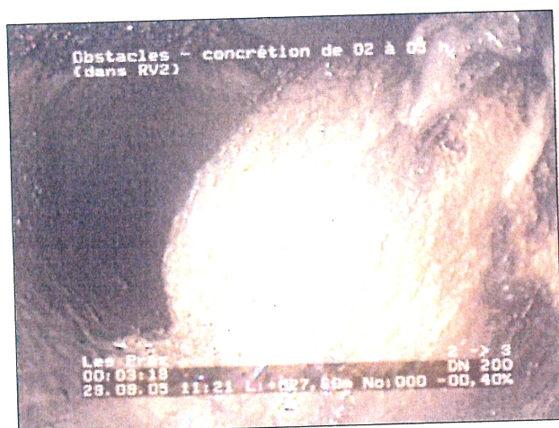
Photo: 1_6a, N° cassette: 1, 00:03:15 27,6m, Obstacles - concrétion de 02 à 05 h. (dans RV2)
