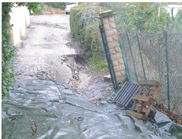
Commune de Sainte Agnès - Glissement de terrain
