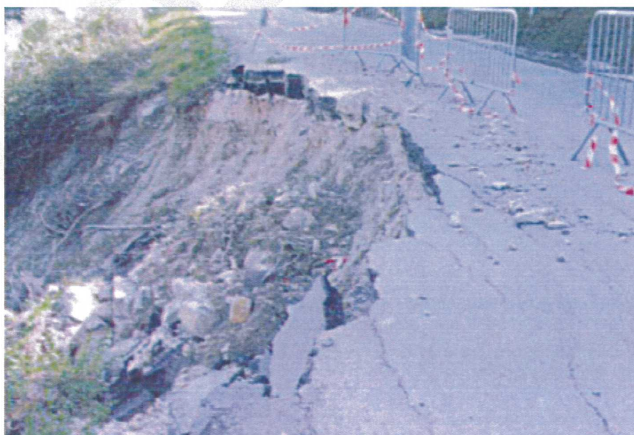
Commune de Menton – Glissement de terrain
