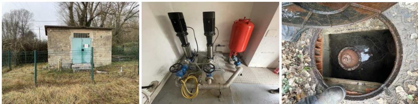
Figure 4 : Photographie de la station de pompage
