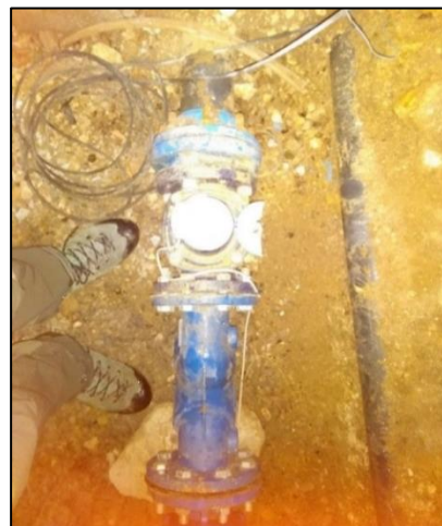
Photo 6 : Intérieur du brise-charge de la Sapie
