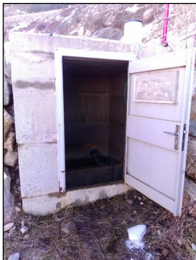
Photo 1 : Captage de Miane
